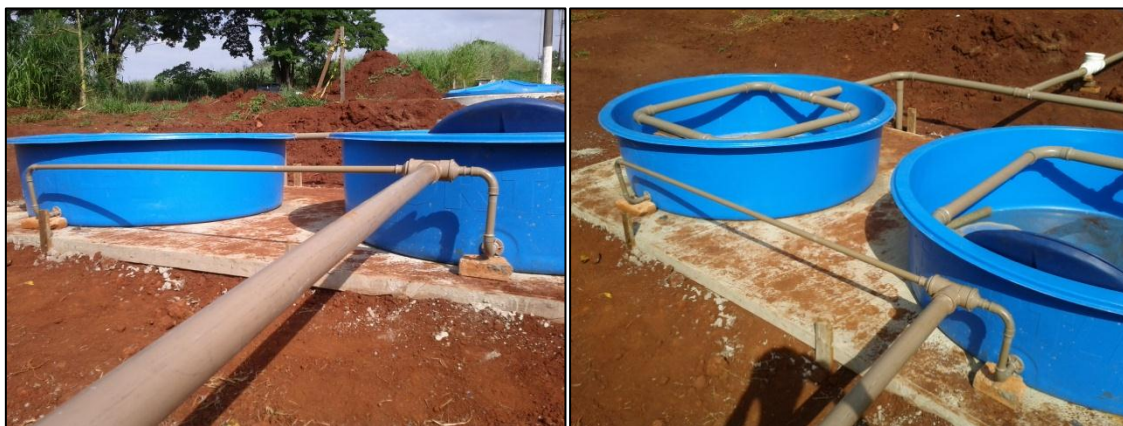
Figura 10. Imagem do sistema de sifão na saída dos tanques (esquerda) e tubulações em forma de quadrado para distribuição igualitária do efluente (direita)
