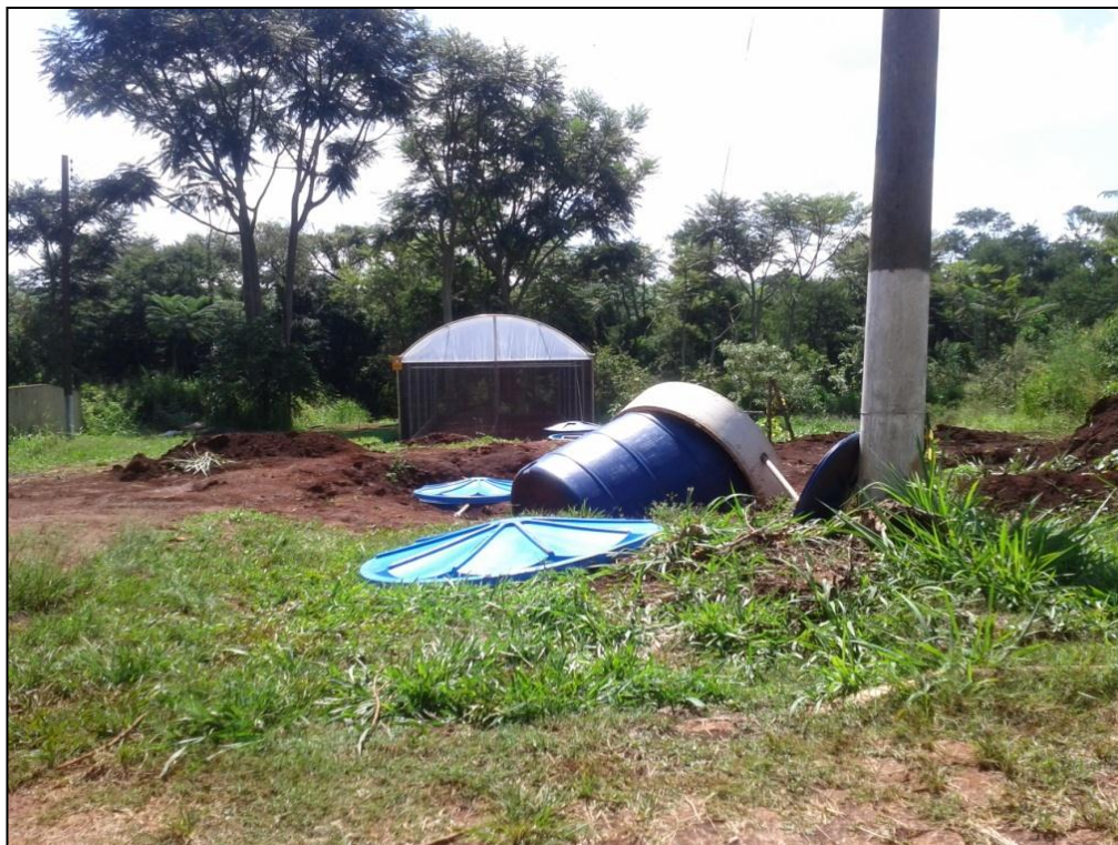
Figura 8. Tanque séptico danificado após a elevação do lençol freático
