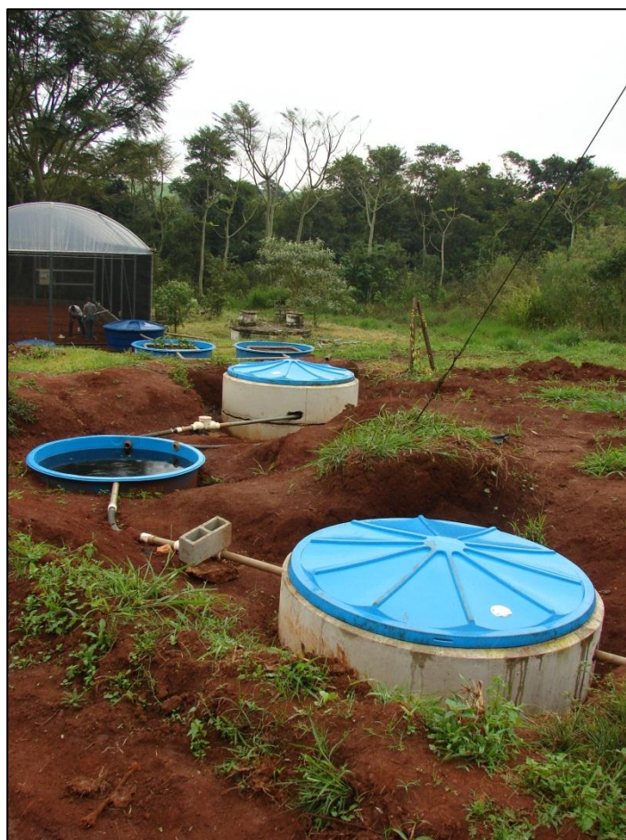
Figura 12. Estação de tratamento conectada e pronta para a recepção do efluente
