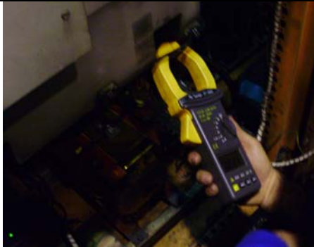
Foto 1: eletricista medindo a corrente de campo do motor
