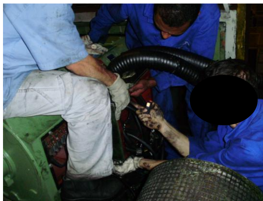
Figura 4.8 – Profissional iluminando a caixa de passagem do motor para efetuar a ligação elétrica
