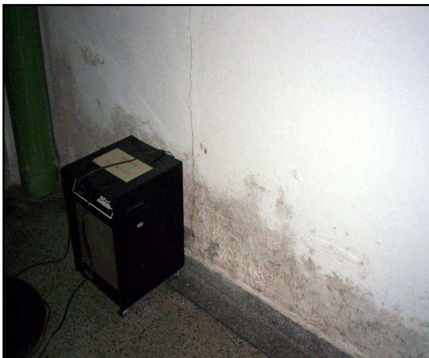
Figura 4.20. Vista do aparelho desumidificador na Biblioteca CQ – USP.
