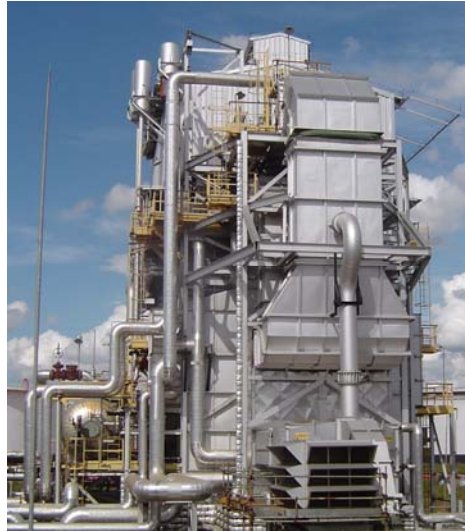
Figura 2.2 – Forno reformador com queimador no topo de unidade industrial de geração de hidrogênio
