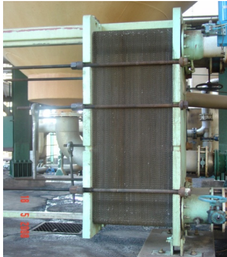
Figura 2.3. Foto do trocador de calor de placas externo à uma das dornas de uma unidade industrial no Estado de São Paulo.
