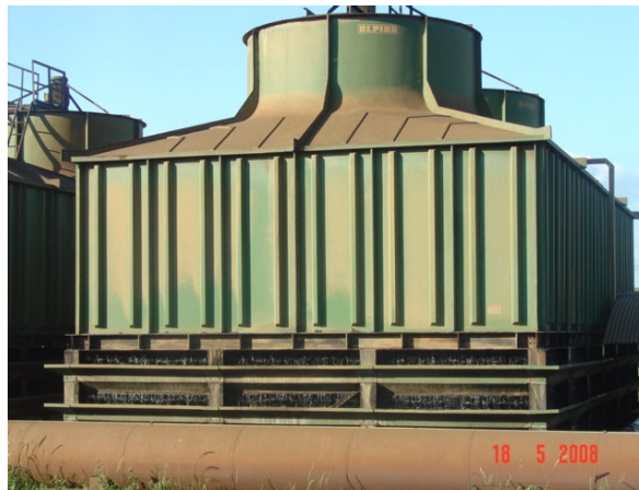
Figura 2.4. Foto de uma das torres de resfriamento de uma unidade industrial no Estado de São Paulo.
