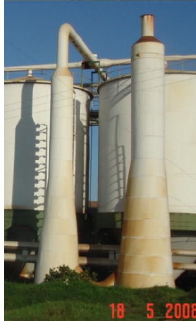
Figura 2.5. Foto da torre de lavagem de dióxido de carbono de uma unidade industrial no Estado de São Paulo.
