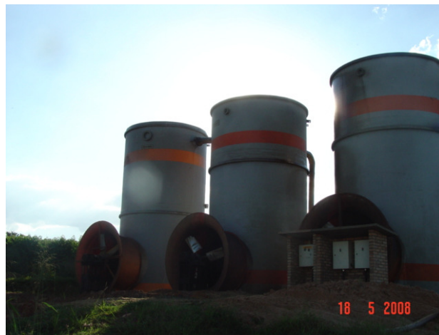
Figura 2.9. Foto dos resfriadores de vinhaça de uma unidade industrial no Estado de São Paulo.
