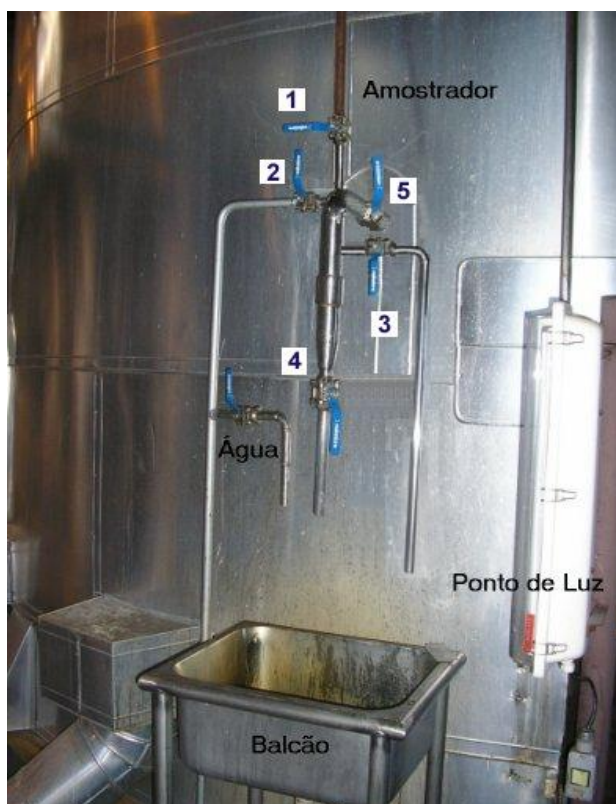
Figura 4.9: Válvulas do amostrador
