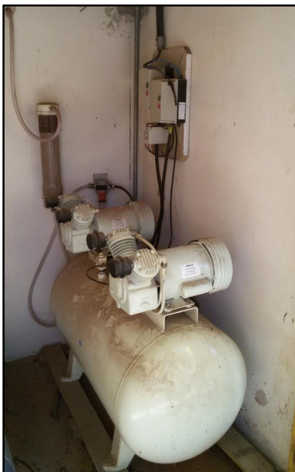
Figura 18 - Compressor de ar
