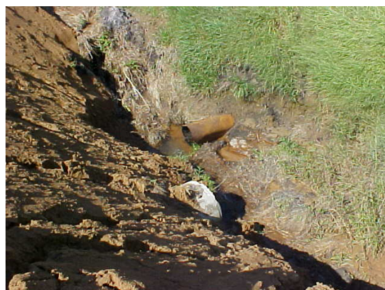
Foto 65: Aspecto do córrego junto à ponte (tamponamento) – erosão decorrente das obras (02/2004).
