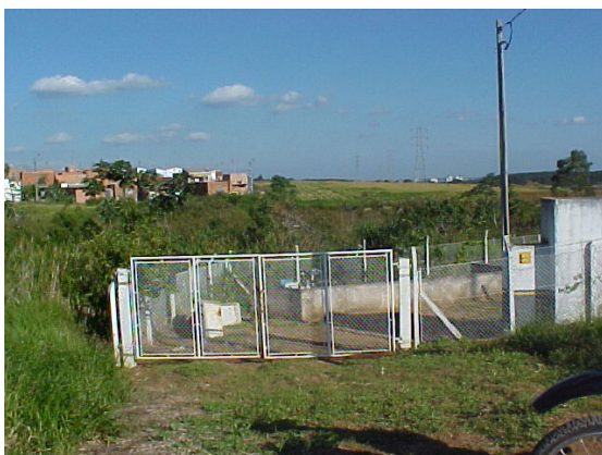
Foto 90: Elevatória de esgoto às margens do córrego (03/2004).
