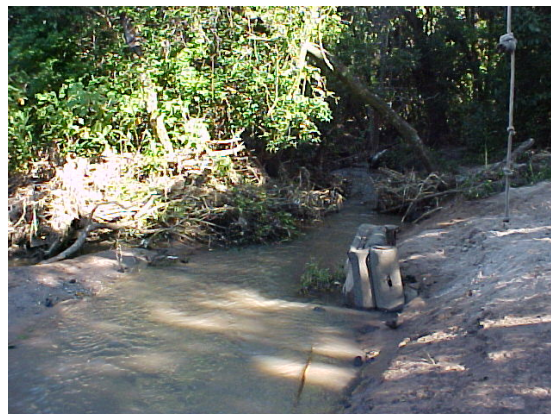
Foto 55: Presença de obstruções (entulho) no canal – um sofá neste caso (02/2004).
