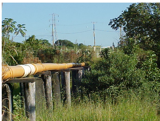
Foto 74: Tronco coletor de esgoto passando sobre o curso d'água (03/2004).
