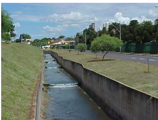
Foto 16: Ocupação de fundo de vale por avenida marginal ( curso d'água canalizado ). Córrego do Tijuco Preto, São Carlos-SP
