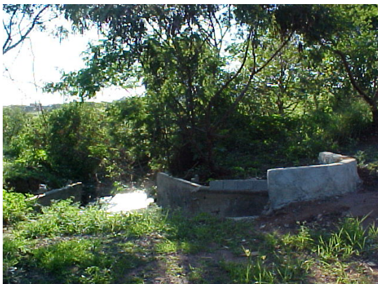
Foto 82: Situação da nascente do córrego Santa Fé em março de 2004 – contenção da erosão e canalização (Plano de recuperação da nascente do córrego Santa Fé realizado pela PMSC).
