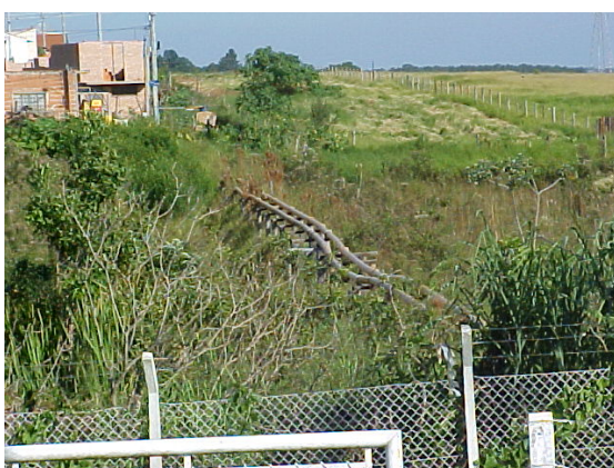
Foto 91: Tronco coletor de esgoto passando sobre o córrego (03/2004).
