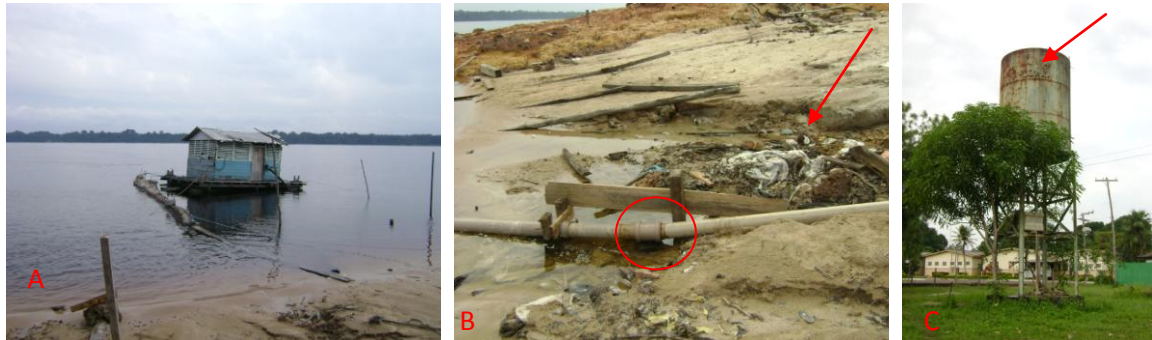
Figura 22 – (A) Captação Superficial no Rio Negro; (B) Tubulação que conduz a água captada no Rio Negro até os tanques aéreos (caixa d'água); (C) Caixa d'água da COSANA em estado precário de conservação, com presença de ferrugem. Fonte: Sarita de Moura.
