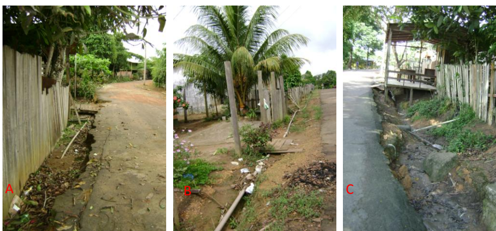
Figura 19 – (A) Rede de abastecimento de água, ora aparente ora enterrada (Bairro Anavilhanas); (B) Rede de abastecimento e a presença de lixo (Bairro Jd. Wilton); (C) Rede de abastecimento aparente ao lado de água que escoa na calçada (Bairro N. Sra. Auxiliadora). Fonte: Sarita de Moura.
