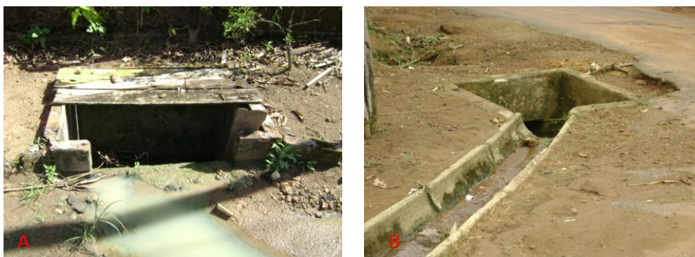
Figura 33 – (A) Bueiro entupido com presença de lixo e restos de vegetação (Bairro N. S. Auxiliadora); (B) Bueiro sem laje de proteção superior (Bairro Remanso). Fonte: Sarita de Moura.
