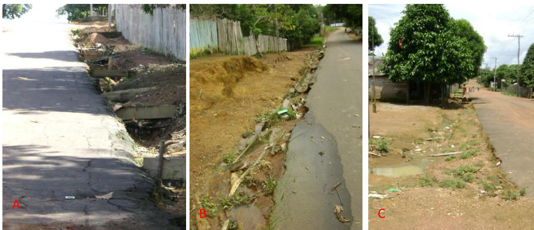
Figura 32 – (A) Improvisação para escoamento das águas pluviais (Bairro N. S. Auxiliadora); (B) Falta de manutenção nas canaletas de concreto para escoamento da drenagem pluvial (Bairro Remanso); (C) Água empoçada nas calçadas por falta de meio-fio, sarjetas e galerias (Bairro Santo Elias). Fonte: Sarita de Moura.
