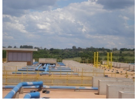
Figura 19 – Vista Superior Reator UASB
