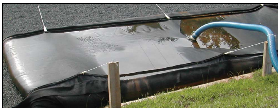
Figura 3.13 – Bag instalado na ETA Santo Antônio do Jardim-SP. Fonte: Tencate Geotube ( www.allonda.com/geotube ).
