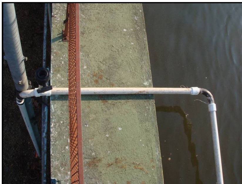
Figura 4.12 – Sistema sifão para coleta de lodo bruto: decantador, à direita; coleta, à esquerda.
