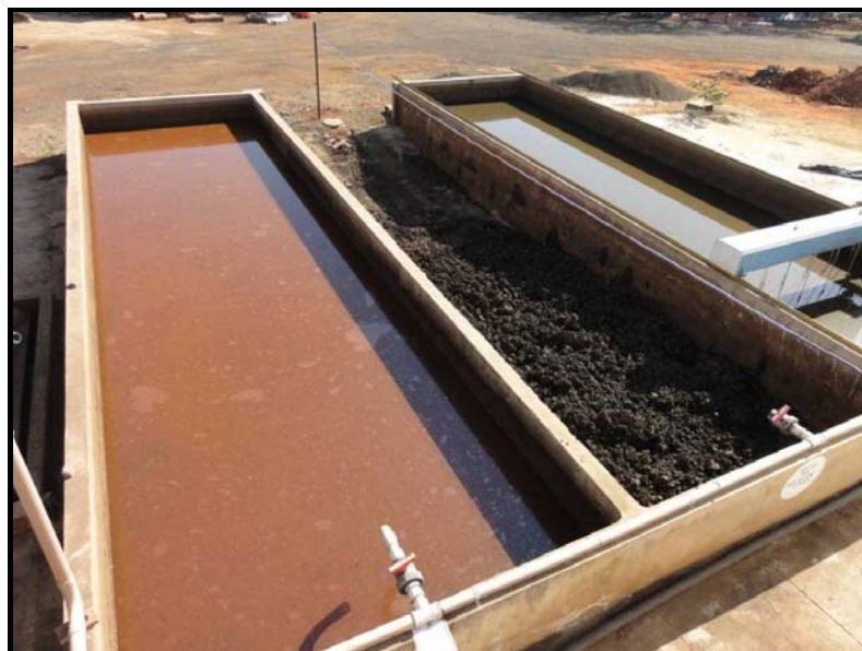
Figura 3.9 – Leitos de secagem – ETA de Nova Odessa-SP. Fonte: Pessoa (2007).
