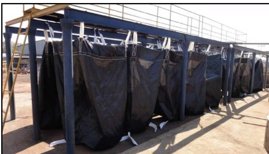
Figura 3.16 – Bags preparados para receber novo despejo de lodo bruto (ETA de Nova Odessa-SP). Fonte: Pessoa (2007).
