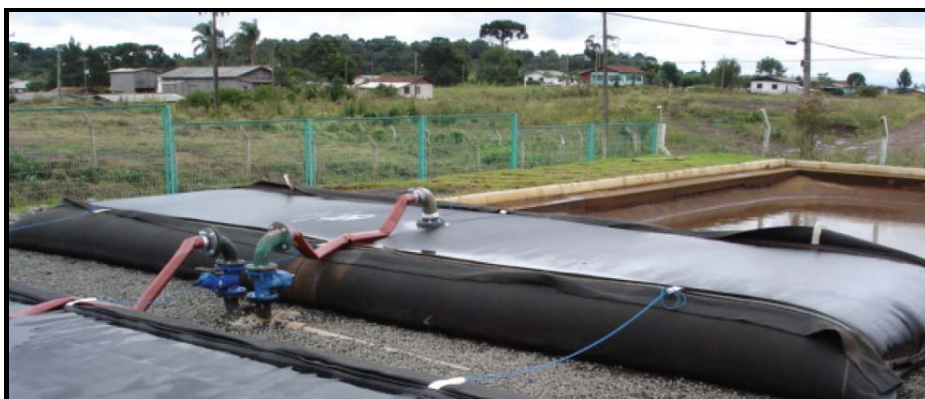
Figura 3.12 – Bags instalados na ETA Curitibanos-SC. Fonte: Tencate Geotube ( www.allonda.com/geotube ).
