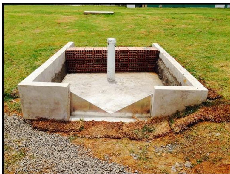
Figura 19 - Vertedor triangular de parede fina de 120° instalado na caixa de alvenaria
