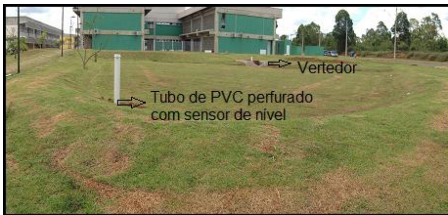
Figura 13 - Localização do tubo de PVC com o sensor de nível no interior do plano de infiltração
