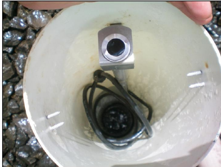
Figura 12 - Instalação do sensor de nível em um tubo de PVC perfurado no interior do plano de infiltração. Fonte: Angelini Sobrinha (2012)
