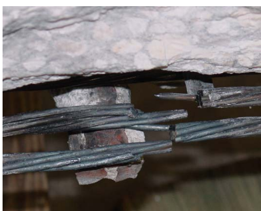
Figura 89 - Detalhe da viga danificada para simular o dano real Fonte: Rehm (2005)
