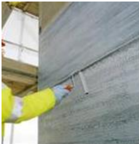
Figura 69 – Pilar de ponte reforçado por GFRP por laminação manual helicoidal Fonte: DENTON (2005)
