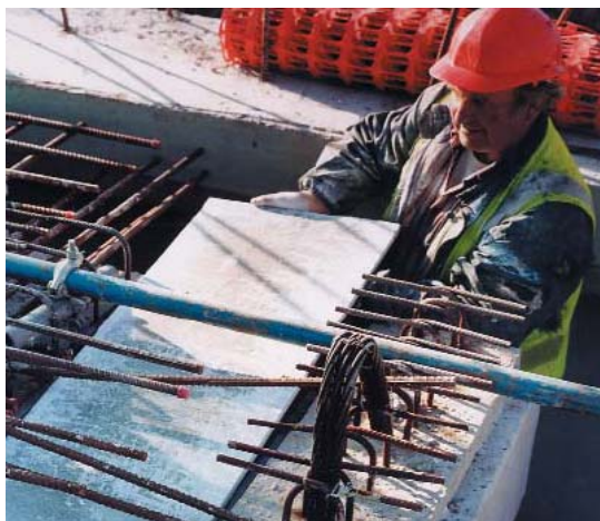
Figura 58 – Painéis GRC usados como fôrma perdida em pontes Fonte: GRCA (2005)
