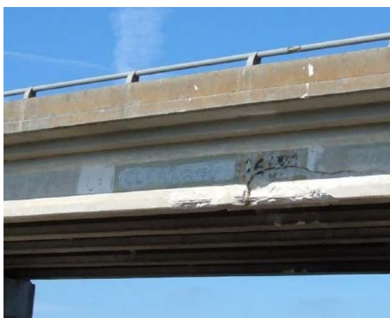
Figura 88 – Viga de viaduto danificada por impacto de carrocerias ou cargas - EUA
