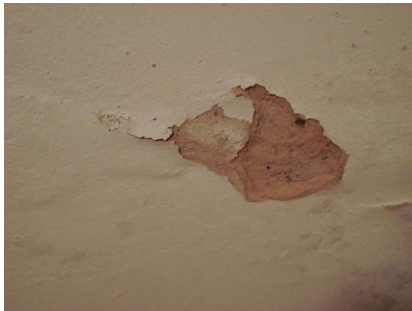
Figura 2.2 – Criptoflorescência, deslocamento de película de tinta e camadas de revestimento
