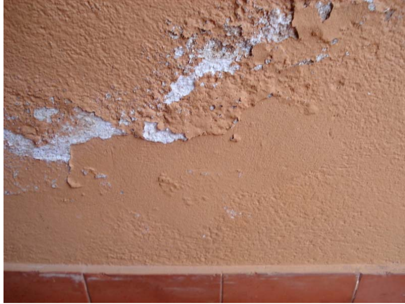
Figura 2.1 – Eflorescência, gerando depósitos esbranquiçados e pulverulentos na superfície
