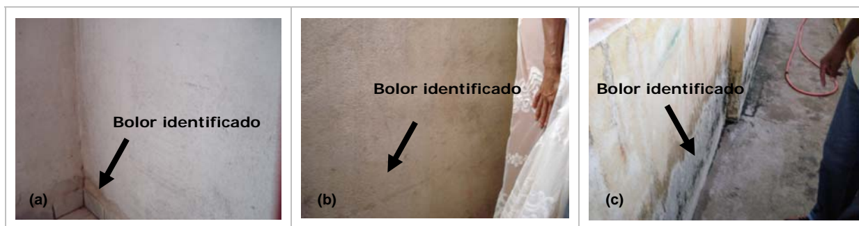
Figura 3.2– Casas com evidências de bolor – casa 1 (a), casa 2 (b) e casa 3 (c)
