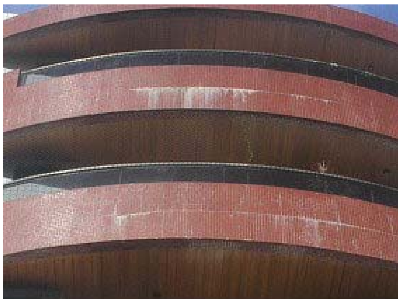
Figura 2.3 – Ocorrência de eflorescência, com depósito de sal branco sobre revestimento cerâmico de fachada. Padilha et al. (2007)
