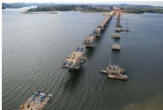
Figura 1.9. Ponte em Balanços Progressivos sobre a Represa de Guarapiranga no Rodoanel de São Paulo (Fonte: DERSA, 2010)
