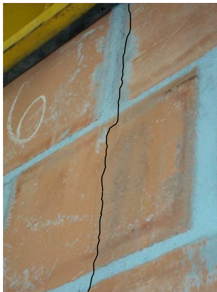
Figura 30 - Modo de ruptura da Parede P1 (trinca vertical)
