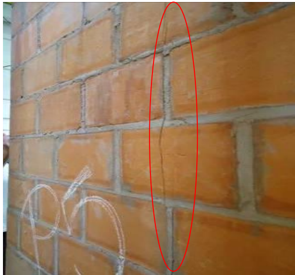
Figura 51 – Forma de ruptura da parede P5 (trinca vertical)
