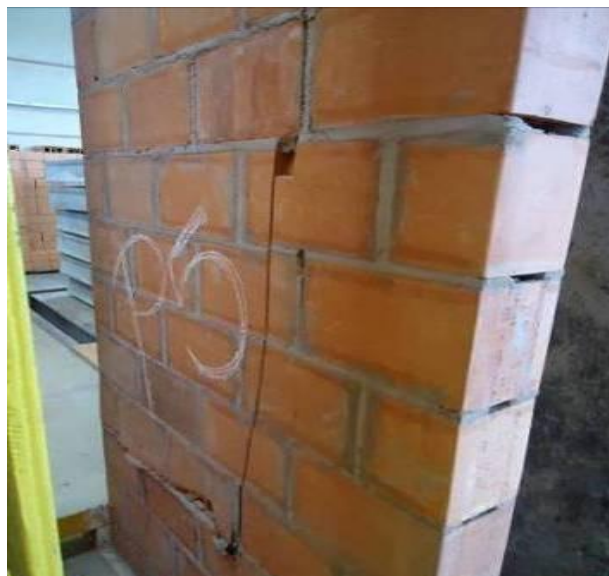
Figura 52 – Parede P5 após ruptura
