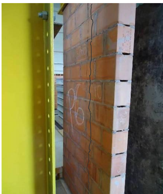
Figura 54 – Forma de ruptura da parede P6 (trinca vertical)
