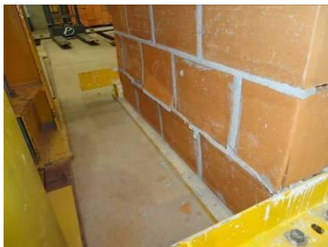
Figura 37 – Parede P3 após ruptura
