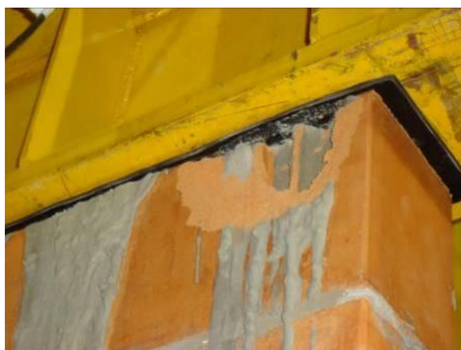
Figura 58 – Parede P10 após ruptura
