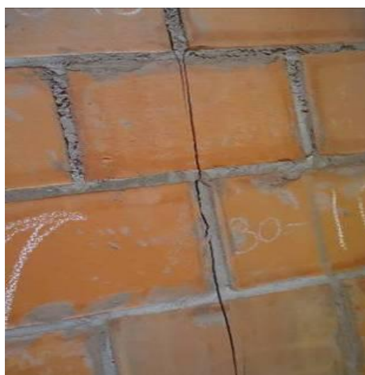
Figura 55 – Parede P6 após ruptura
