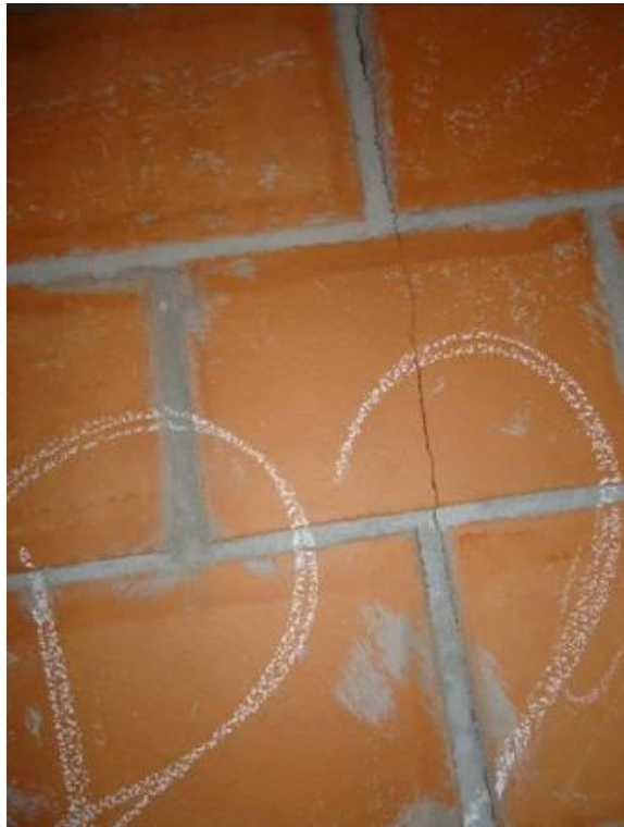
Figura 33 - Modo de ruptura da parede P2 (trinca vertical)
