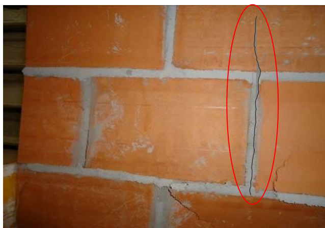
Figura 36 – Forma de ruptura da Parede P3 (trinca vertical)
