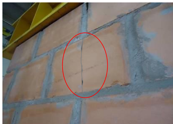
Figura 39 – Forma de ruptura da Parede P7 (trinca vertical)
