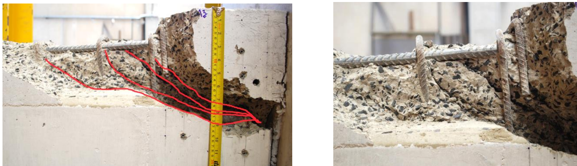
a) Fissuras delimitando as bielas de concreto
