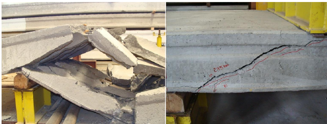
Figura 2.5: Rupturas por tração diagonal em lajes alveolares
