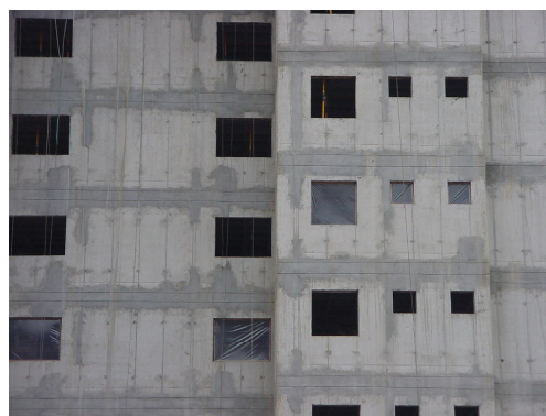
FOTO 12: ASPECTO DAS FACHADAS COM A EXECUÇÃO DAS PAREDES EM CONCRETO ARMADO MOLDADO “IN LOCO”.
