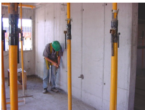
FOTO 11: TRATAMENTO INTERNO DADO NAS PAREDES DE CONCRETO MOLDADO “IN LOCO” PARA POSTERIOR PINTURA.
