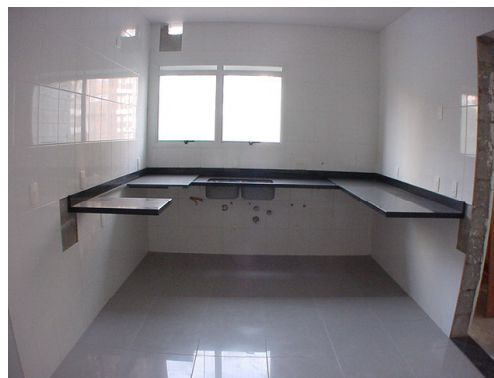
FOTO 8: REGIÃO DA COZINHA COM TODAS AS INSTALAÇÕES EMBUTIDAS NAS PAREDES.
