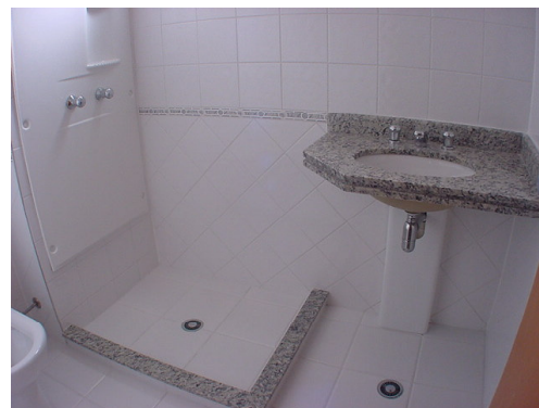
FOTO 18: CARENAGEM EM FIBRA, REMOVÍVEL, INSTALADA SOBRE A TUBULAÇÃO EXISTENTE ABAIXO DA BANCA DO BANHEIRO.
