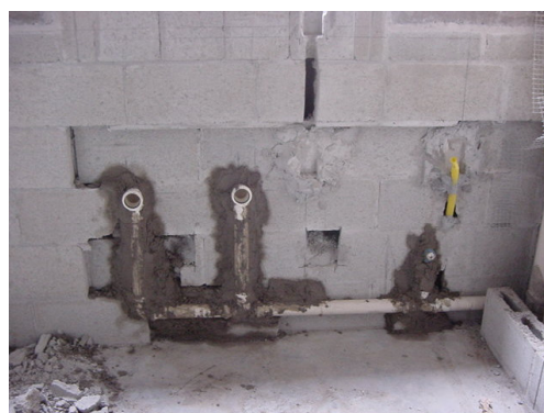
FOTO 6: DISTRIBUIÇÃO HIDRO-SANITÁRIA NAS PAREDES, EXECUTADA COM TUBULAÇÃO RÍGIDA E EMBUTIDA NA ALVENARIA.
