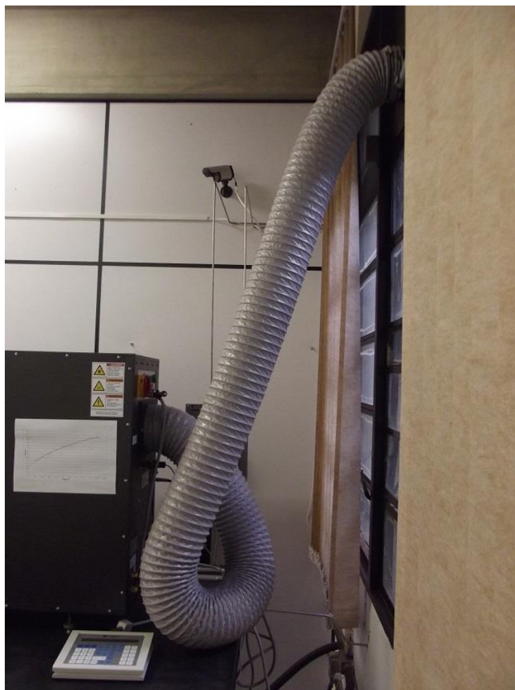
Figura 38 – Duto do sistema de exaustão do laser.
