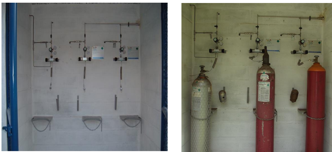
Figura 36 – Central de gases construída na parte externa ao laboratório.
