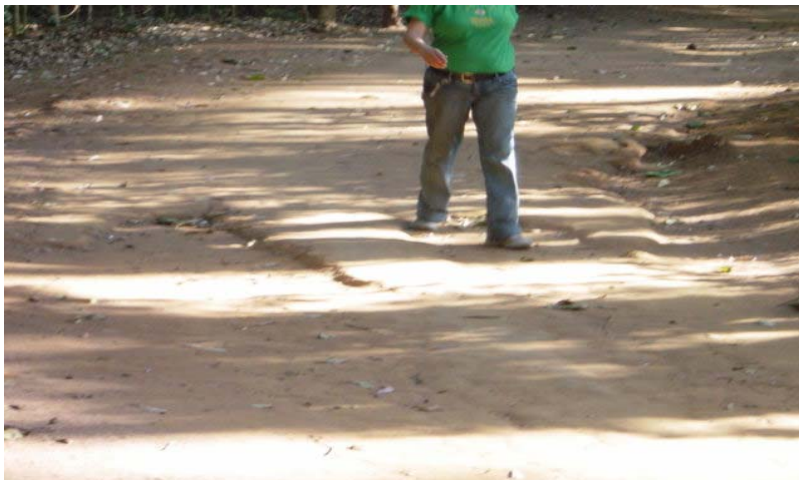
Figura 10. Visão parcial das condições do piso da PS/UFSCar.
