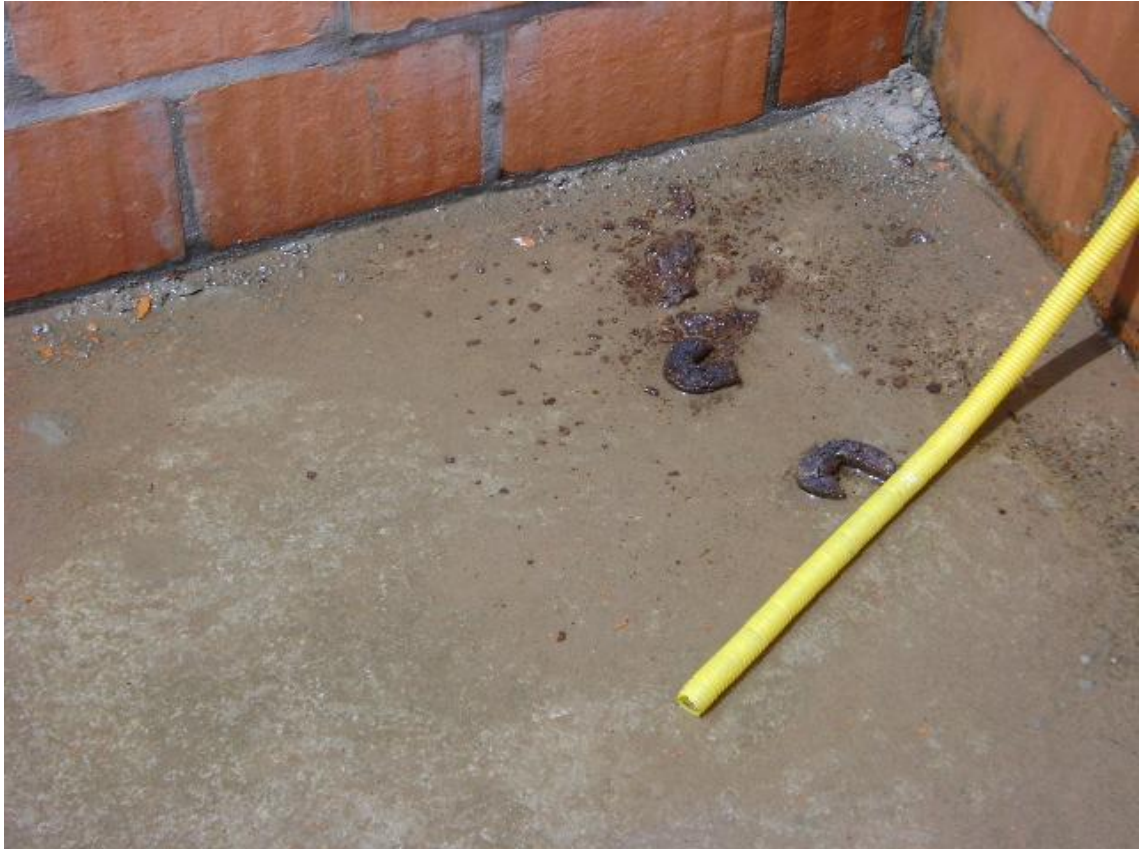
Foto 9 – fezes dentro de uma casa em construção
