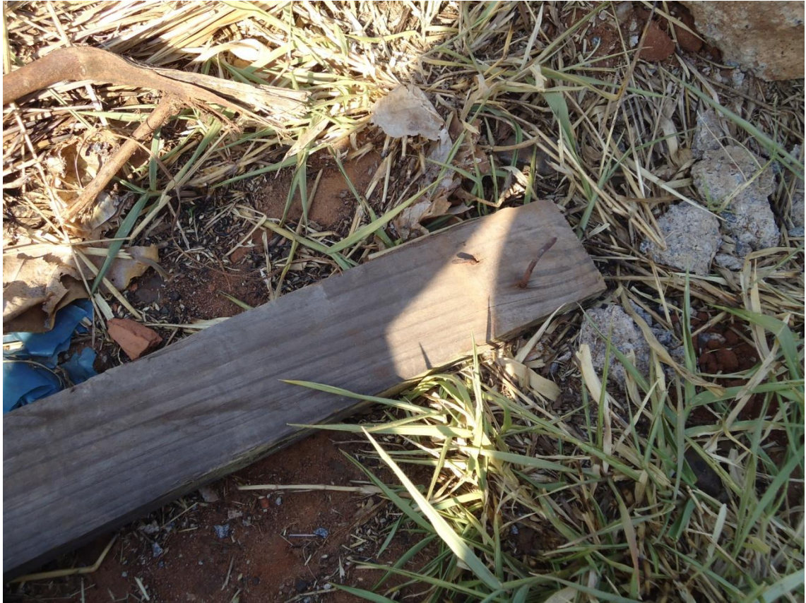
Foto 16 – Pedaco de madeira com prego encontrado no terreno da obra.
