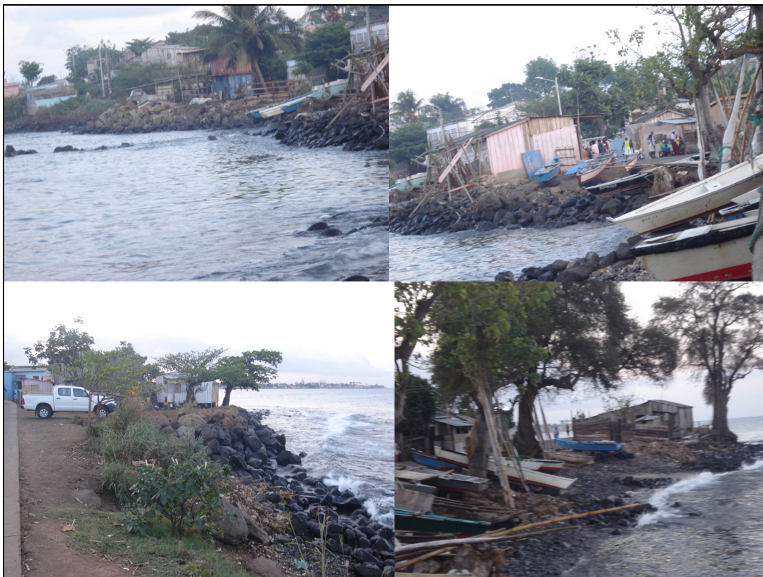
Figura 11 – Extinção da praia na comunidade de Pantufo decorrente da erosão marinha
