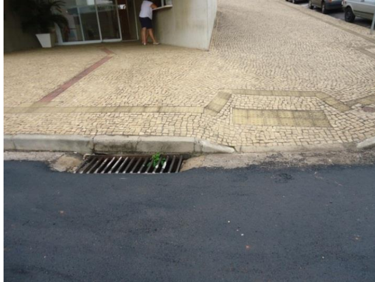
Figura 65 - Rebaixamento de guia revestido com pedra portuguesa. 2013
