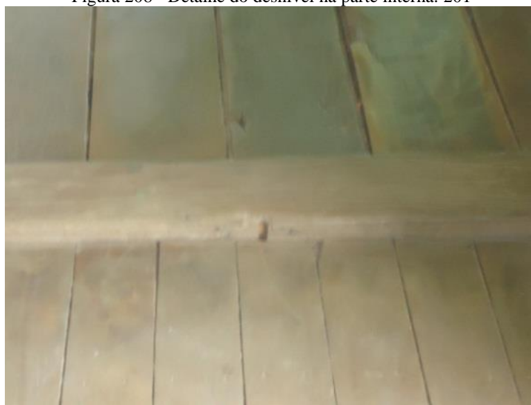
Figura 208 - Detalhe do desnível na parte interna. 201
