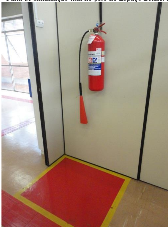
Figura 232 - Falta de sinalização tátil no piso no Espaço Braile. Janeiro/2014
