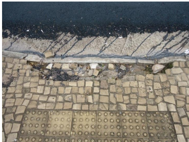
Figura 66 - Rebaixamento de guia com pedras soltas e desnível entre o leito carroçável e a começo da rampa. 2013
