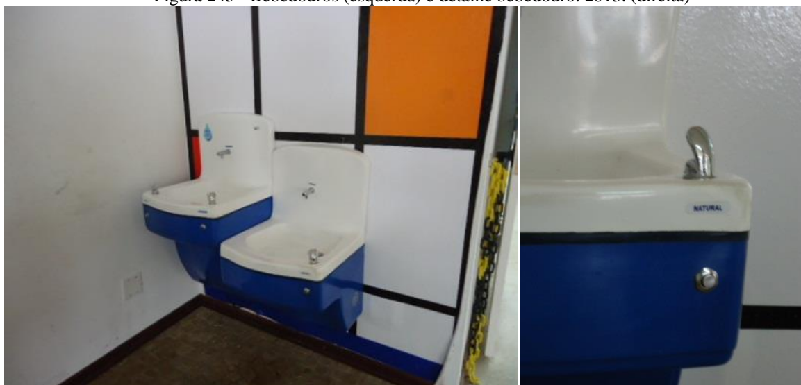
Figura 245 - Bebedouros (esquerda) e detalhe bebedouro. 2013. (direita)
