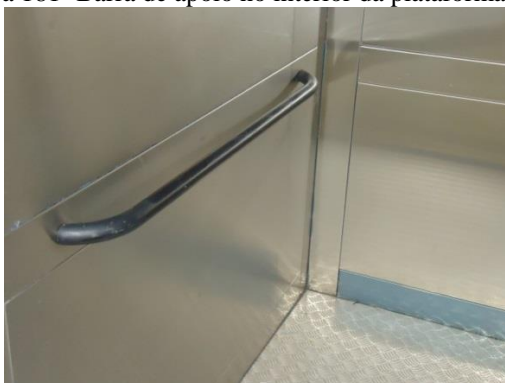
Figura 181- Barra de apoio no interior da plataforma. 2013
