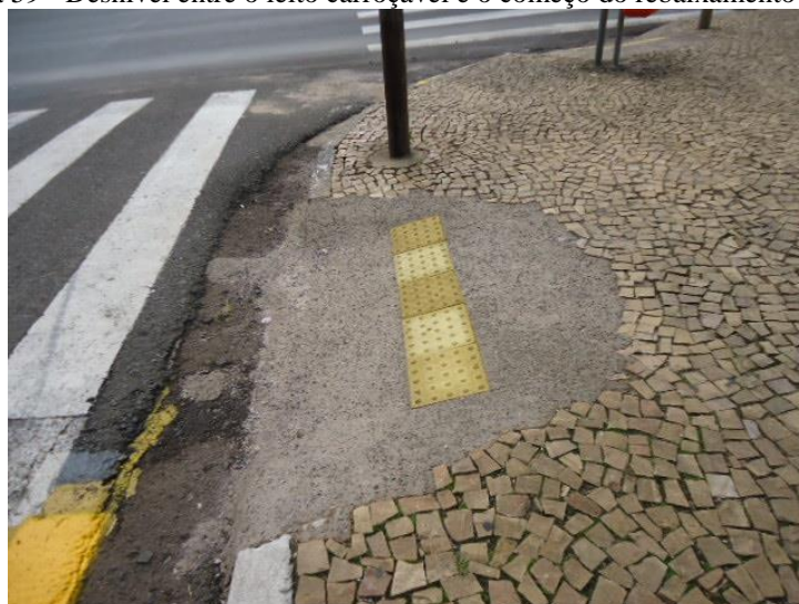
Figura 59 - Desnível entre o leito carroçável e o começo do rebaixamento da guia
