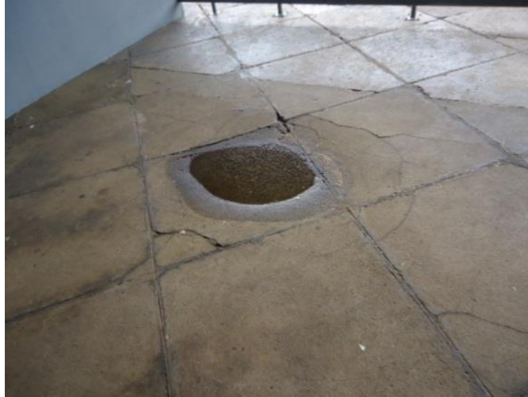
Figura 68 - Rachaduras no piso da área externa coberta. 2013
