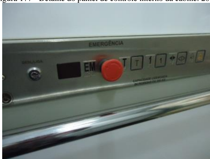
Figura 177 - Detalhe do painel de controle interno da cabine. 2013.
