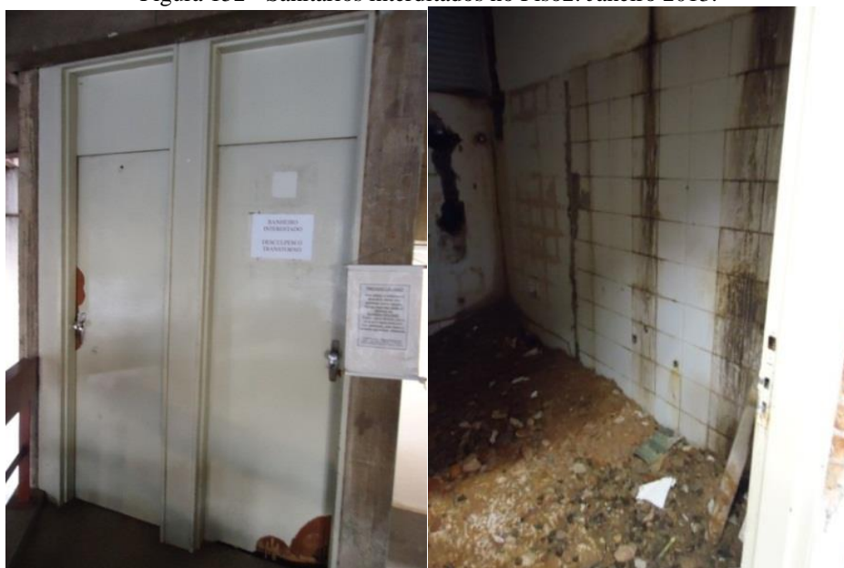
Figura 152 - Sanitários interditados no Piso2. Janeiro 2013.
