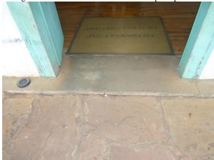
Figura 73 - Desnível na soleira da entrada principal. 2013
