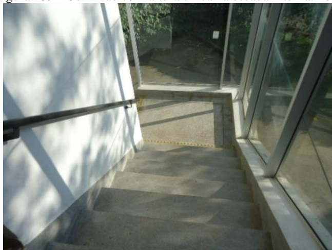
Figura 139 - Corrimão com altura única na escada interna. 2013
