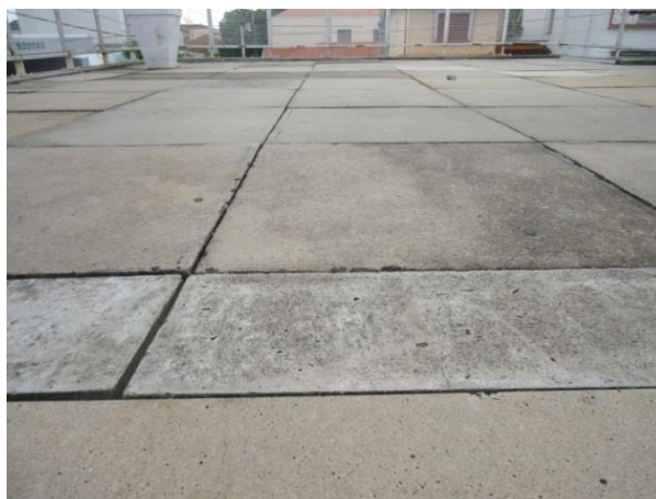
Figura 257 - Detalhe das placas de concreto na “praça” do Teatro Municipal. 2013
