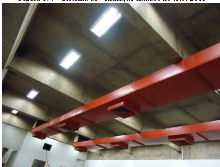
Figura 197 - Sistema de ventilação fixados no teto. 2013
