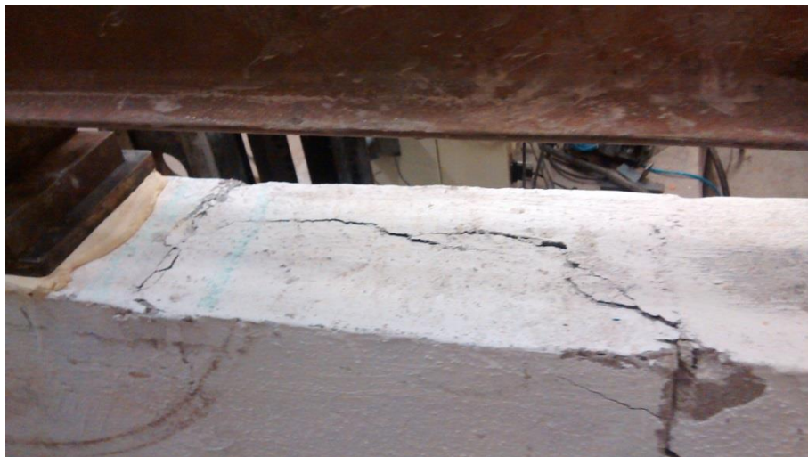
Figura 59 - Fissuras no Bloco
