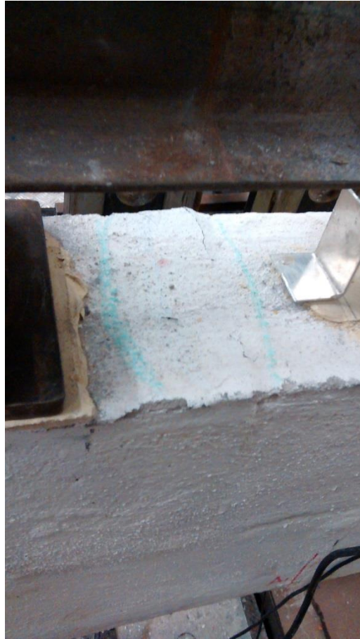
Figura 56 - Fissura na Junta do Bordo Superior da Viga
