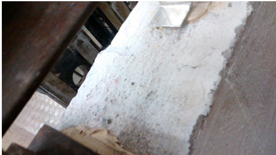
Figura 55 - Estufamento e Fissura na Junta
