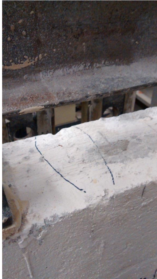
Figura 69 - Estufamento e Fissura na Junta
