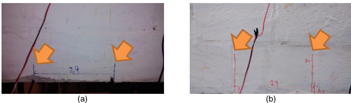
Figura 43 - Fissuração das Vigas
