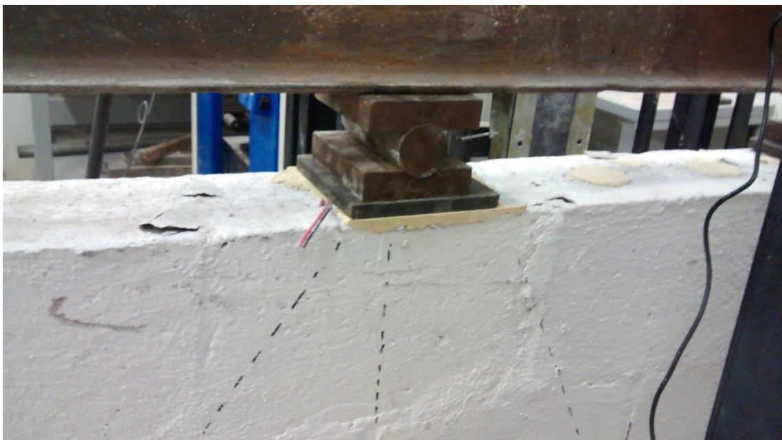
Figura 51 - Fissura na Junta do Bordo Superior da Viga
