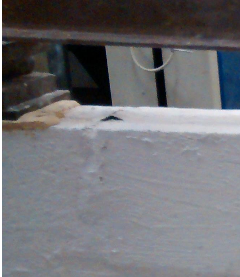
Figura 70 - Destacamento na Região próximo da Carga
