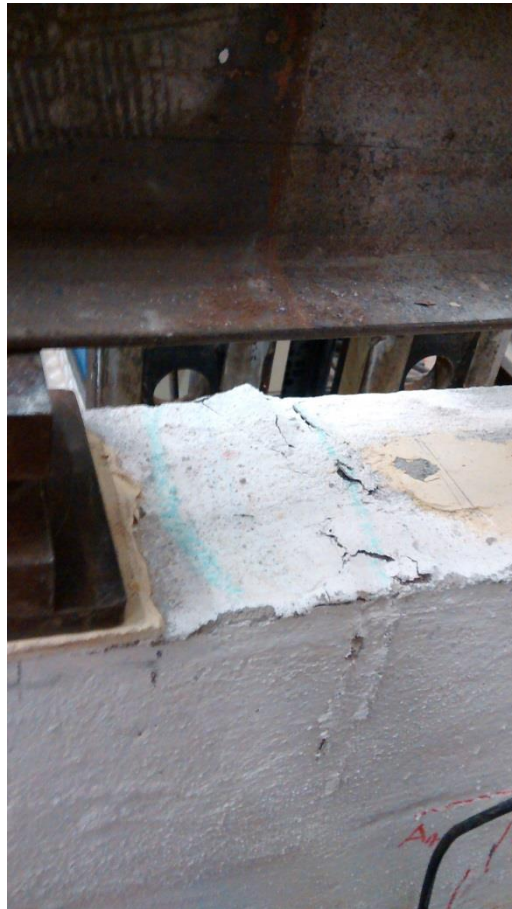
Figura 57 - Destacamento na Região próximo da Carga
