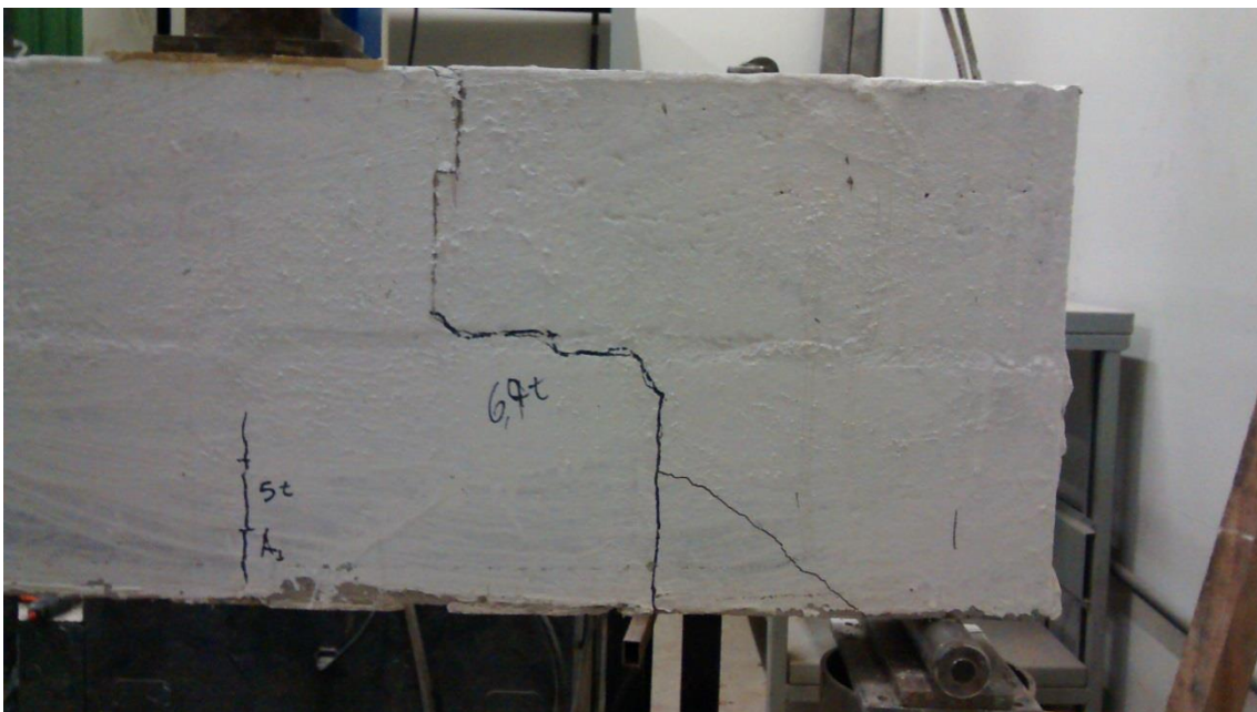
Figura 62 – Aumento das Fissuras
