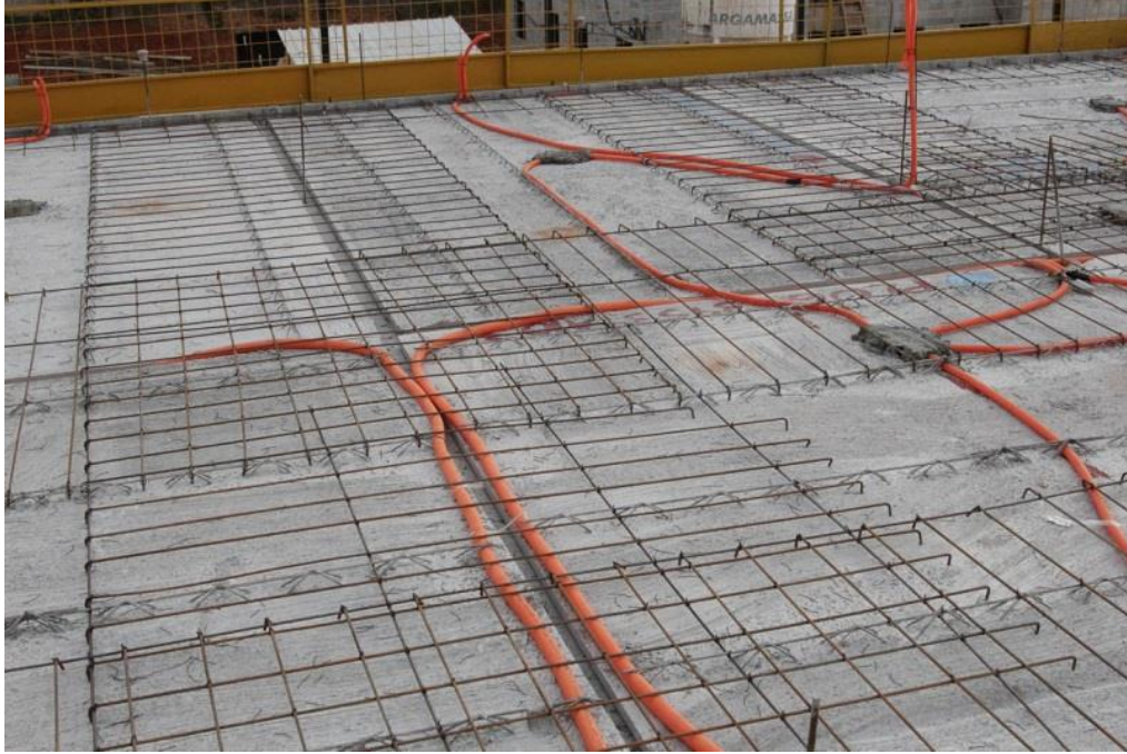
Figura 5- Preparação do painel treliçado (colocação de ferros complementares, embutimento de tubulações, etc) para concretagem definitiva.
