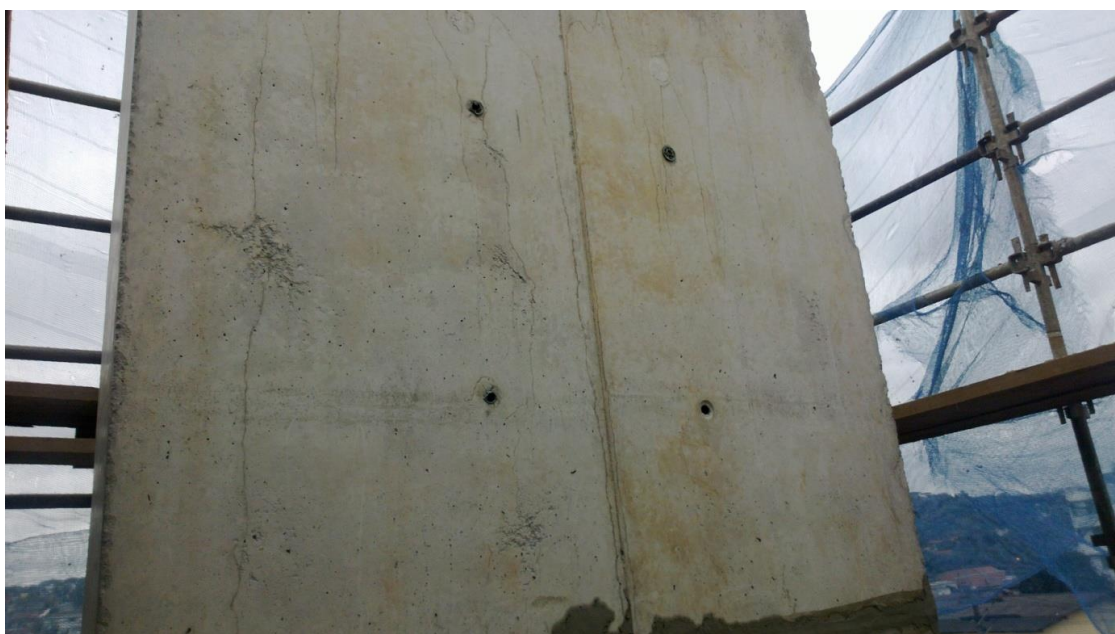
Figura 9 - Exemplo de estrutura fissurada por cura química deficiente.
