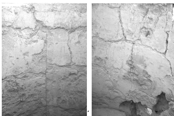
Figura 5.48: À direita, trincas na parede do cadinho após 10 meses de uso. À esquerda, cavidade aberta para o conserto da válvula.
