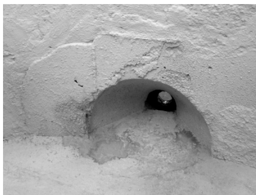
Figura 5.49: Válvula gaveta após o preenchimento completo e já pintado com tinta refratária anti-molhante.
