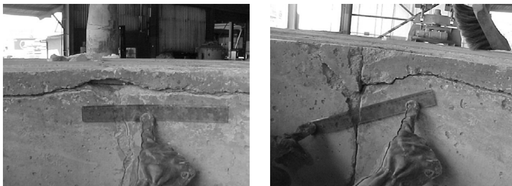
Figura 5.23: À esquerda: Trinca superior próximo ao apoio da tampa. À direita: Outro exemplo de trinca na parte superior.
