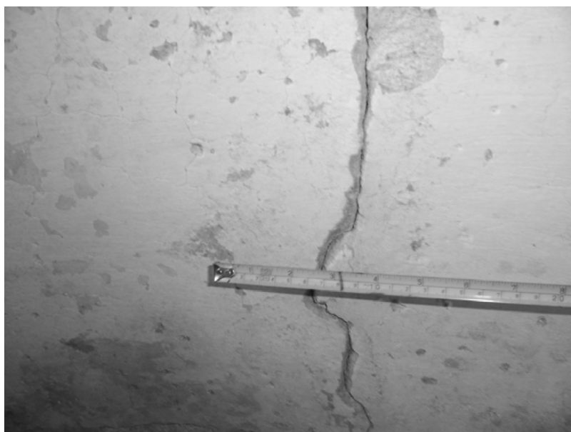
Figura 4.12: Medição da largura da trinca encontrada no revestimento monolítico
