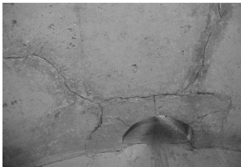
Figura 5.24: Concentração de trincas na saída da válvula gaveta
