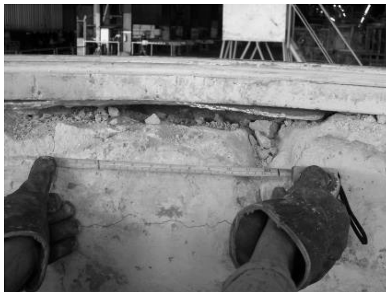
Figura 5.28: Infiltração do alumínio no topo entre o refratário e a carcaça.
