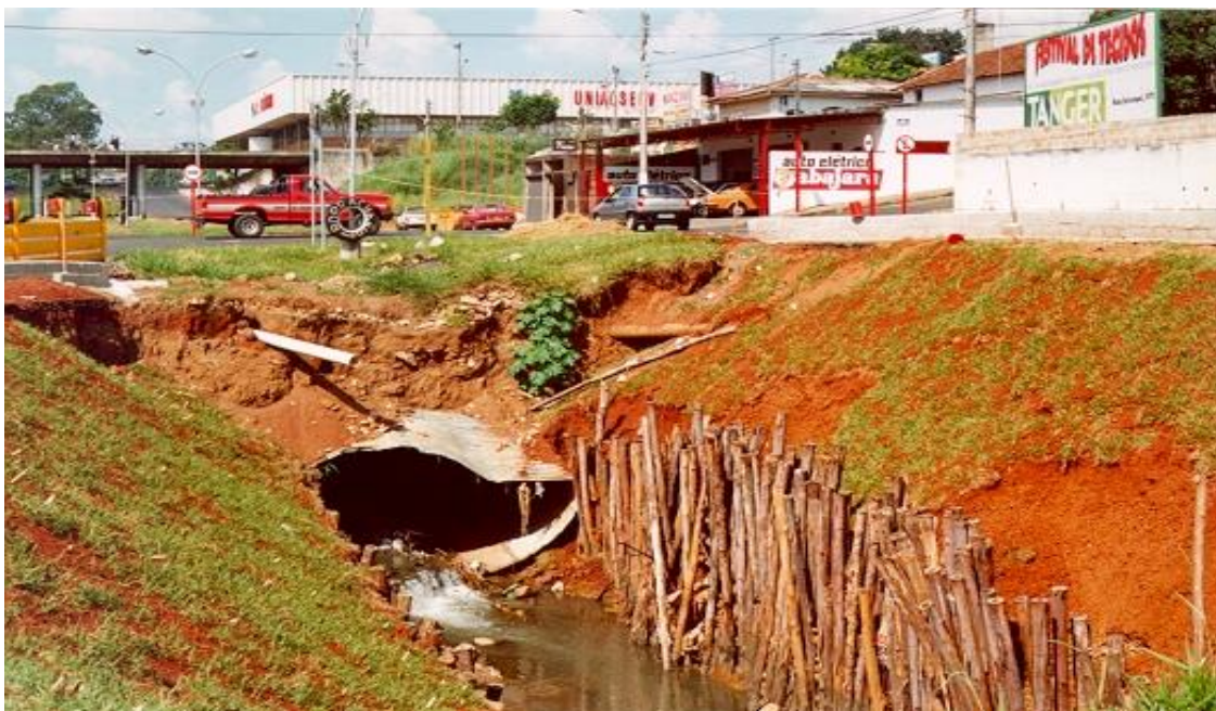
Figura 9 – Desastre no Tamponamento do Córrego Tijuco Preto, São Carlos, SP. Foto: FRANCISCO, J. 1998.
