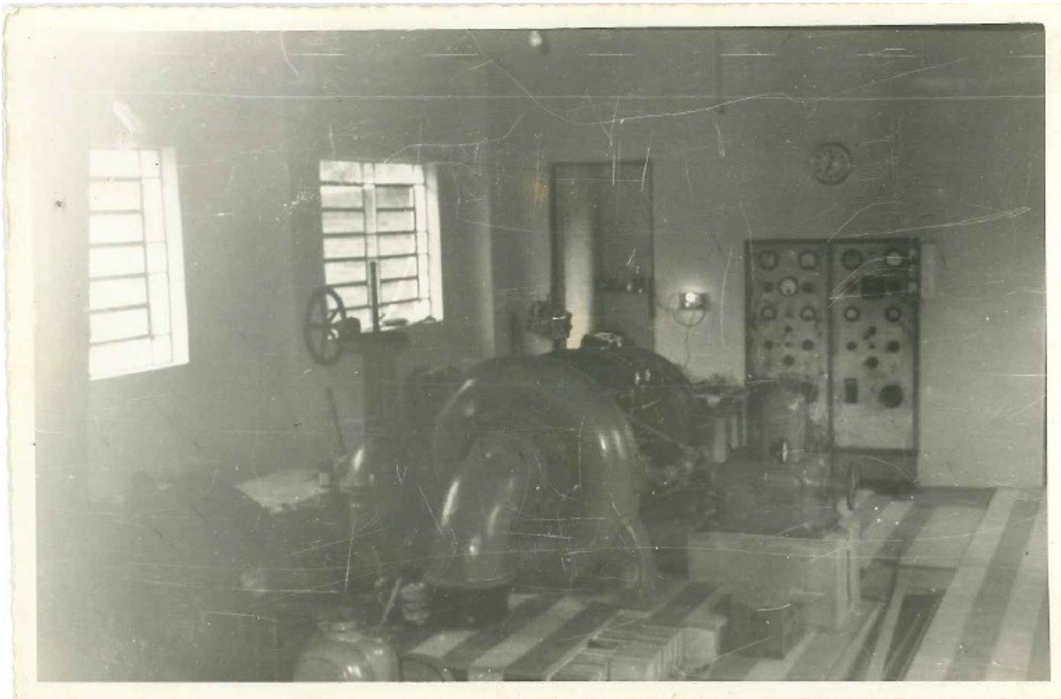
Figura 10- Casa de Máquina de Hidrelétrica da Escola na década de 1950
