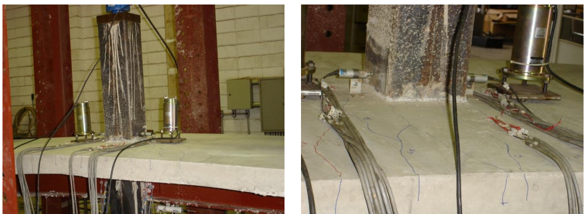
Figura 4.8 - Distribuição das fissuras no modelo experimental (DE NARDIN, 2007)
