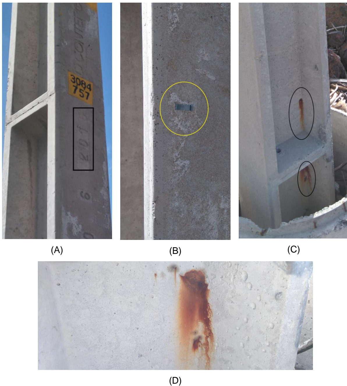
Figura 3.55 Poste recém instalado na Praia de Panaquatira em São Luís (MA). (A) Indicação de fabricação em 2015. (B) Espaçador da armadura exposto. (C) Manchas avermelhadas produzidas pelo óxido de ferro, originário da corrosão da armadura. (D) Aproximação da foto anterior, mostrando a solução com produtos da corrosão migrando pelos poros superficiais.
