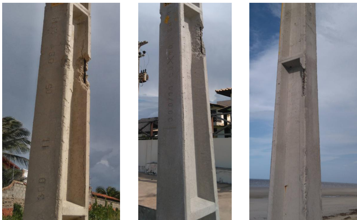
Figura 2.21 Arrancamento de parte da cobertura de concreto do poste, na região do centro de gravidade, provavelmente ocasionado por erros na movimentação da peça.
