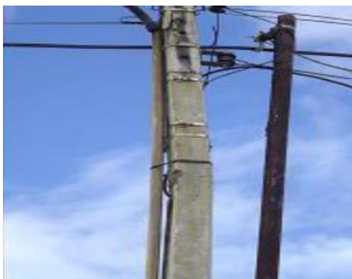
Figura 2.11 Exemplo de ação conjunta de sollicitação mecânica e meio corrosivo levando a ruptura do poste de concreto [65] .
