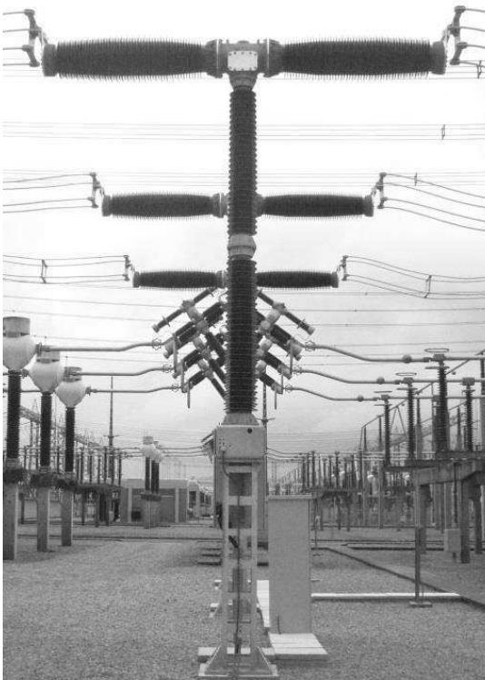
Figura 18 - Segundo modelo de disjuntor a SF6, pátio 345kV
