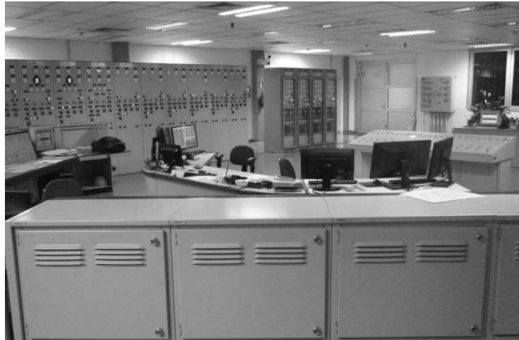
Figura 7 - Vista parcial (da frente para o fundo) da sala de controle da subestação de energia elétrica em estudo
