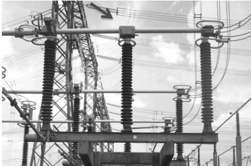
Figura 21 - Seccionadora fechada, do pátio 345kV
