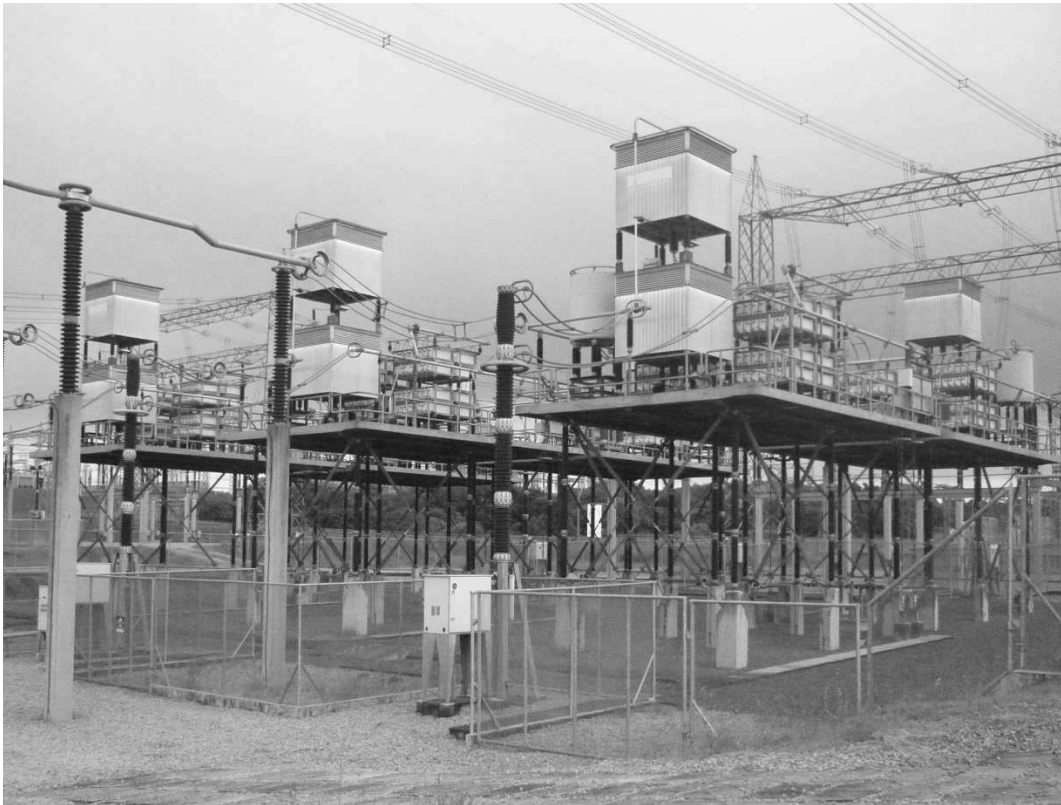
Figura 27 - Banco de capacitor série, 500kV
