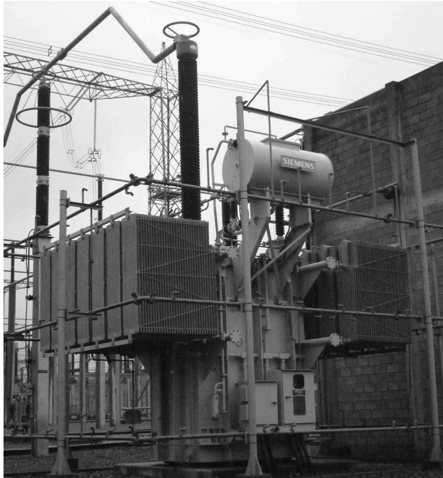
Figura 29 - Reator de barra, 500kV
