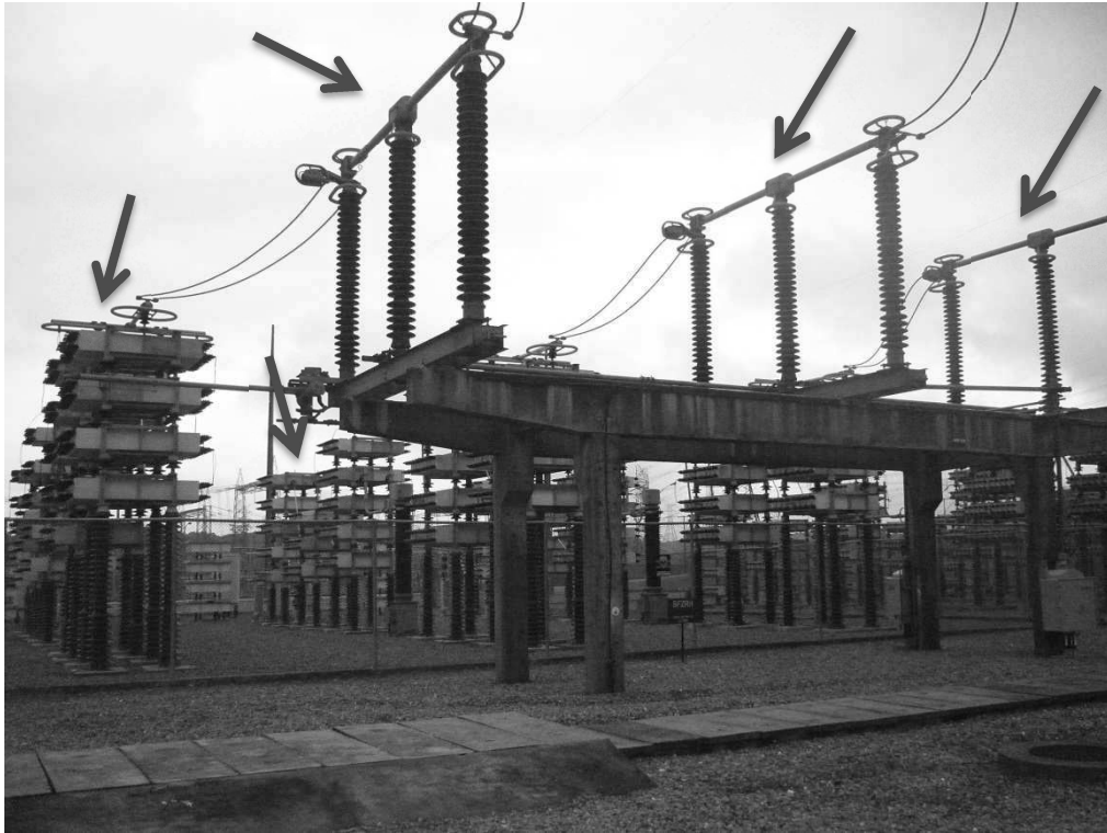
Figura 23 - Seccionadora e banco de filtros, 345kV
