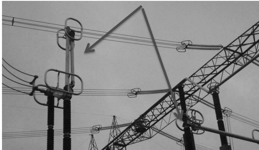
Figura 22 - Seccionadora aberta, pátio 500kV
