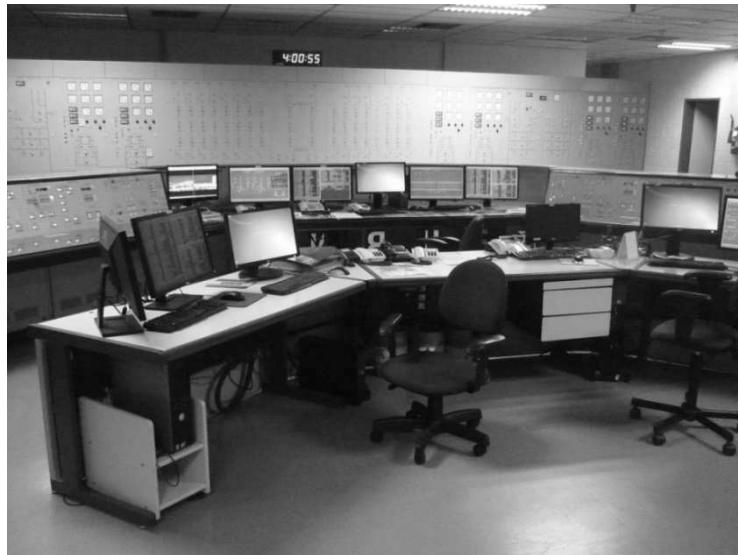
Figura 6 - Vista parcial (do fundo para frente) da sala de controle da subestação de energia elétrica em estudo
