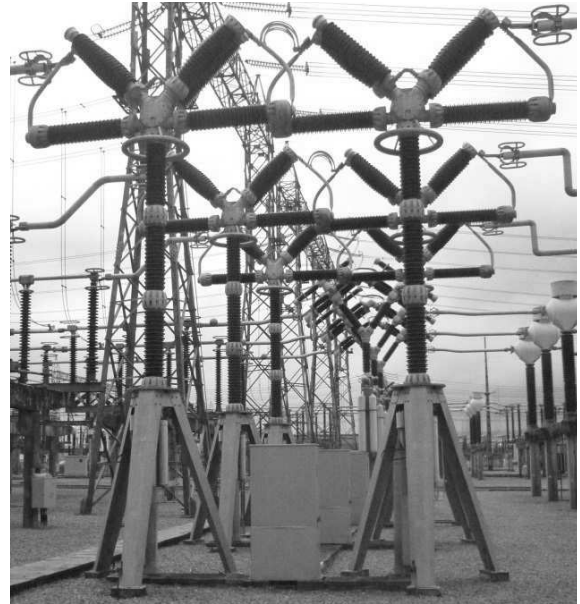
Figura 17 - Disjuntor a SF6, pátio 345kV
