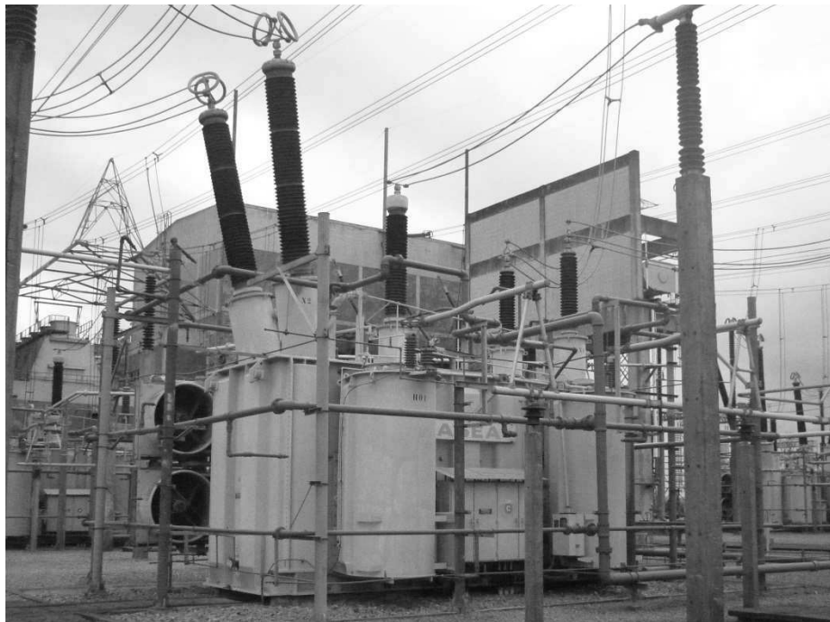
Figura 26 - Transformador conversor, 345kV
