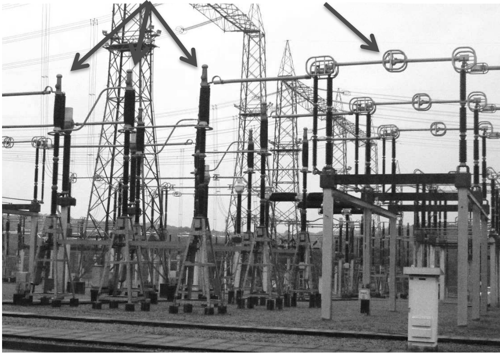
Figura 20 - Quarto modelo de disjuntor a SF6 e seccionadora isoladora fechada, pátio 500kV
