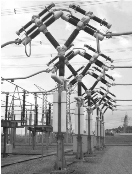
Figura 16 - Disjuntor a ar comprimido, pátio 345kV
