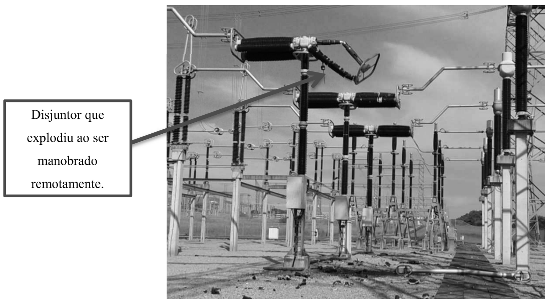
Figura 34 - Disjuntor danificado devido à explosão após manobra, pátio de 500kV
