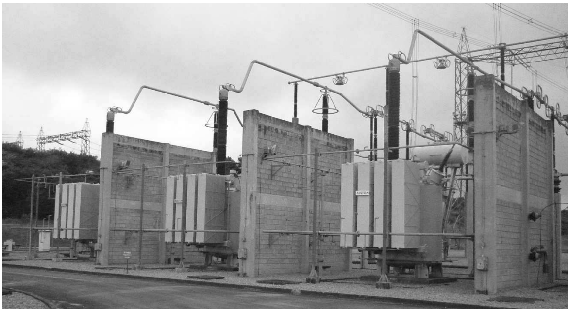
Figura 28 - Reatores de linha, 500kV
