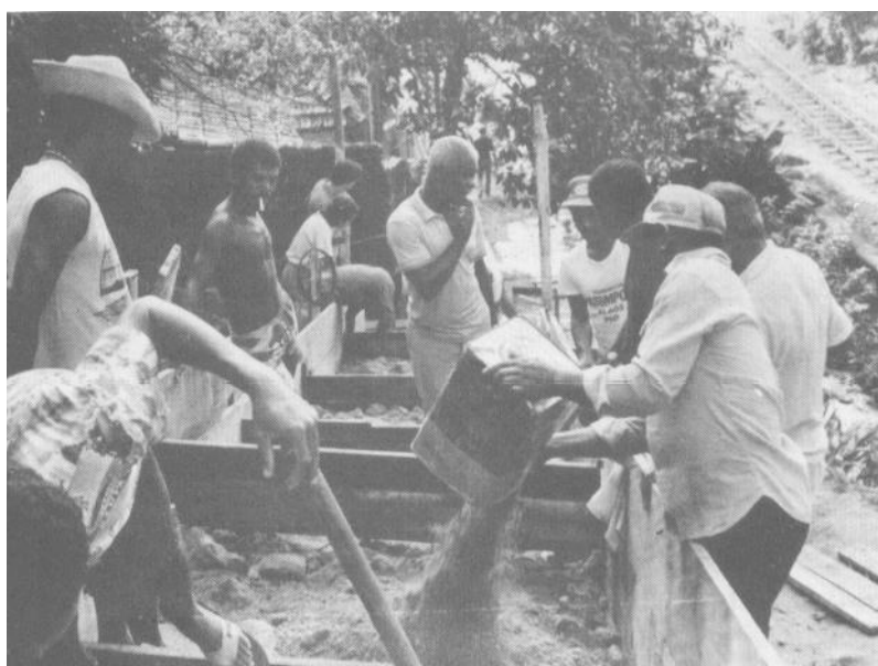
Figura 5.1.11. Escadarias no Morro José Menino. Execução em esquema de mutirão com a finalidade de envolver a população com o programa de regularização a ser executado no morro. Fonte: PMS (1992).
