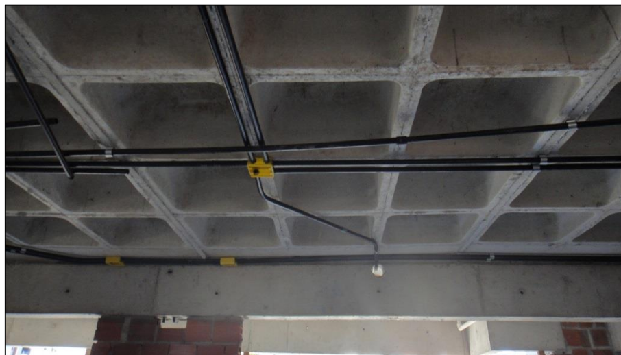
Figura 56 - Instalações elétricas sobre o forro de gesso – Empresa C
