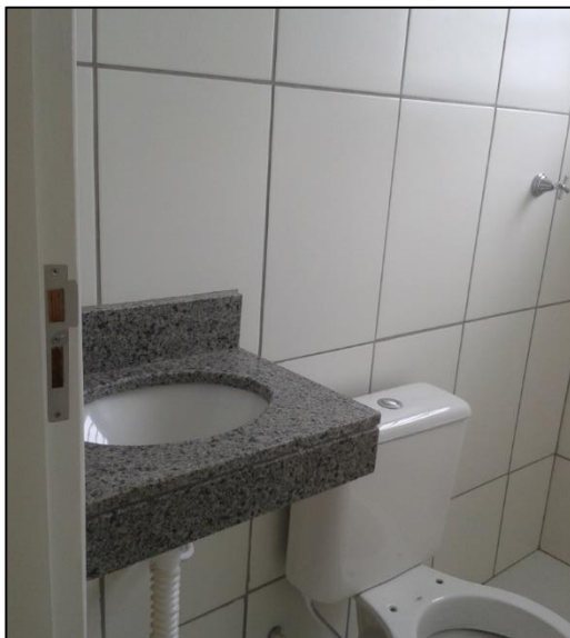
Figura 34 - Banheiro com personalização em granito tipo 1 e revestimento até o teto – Empresa A
