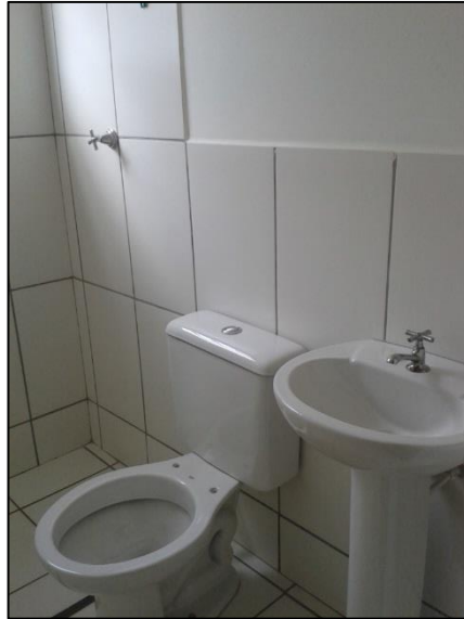
Figura 33 - Banheiro padrão – Empresa A
