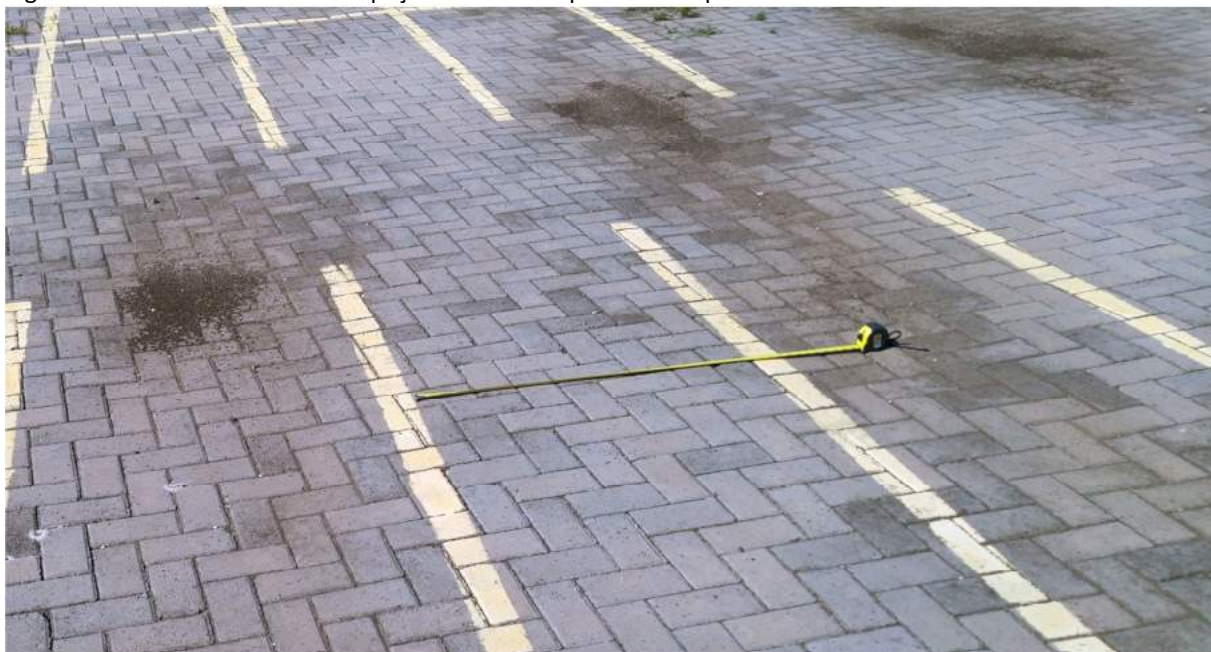
Figura 57 – Estacionamento do Espaço Cultural – Depressões no piso.
