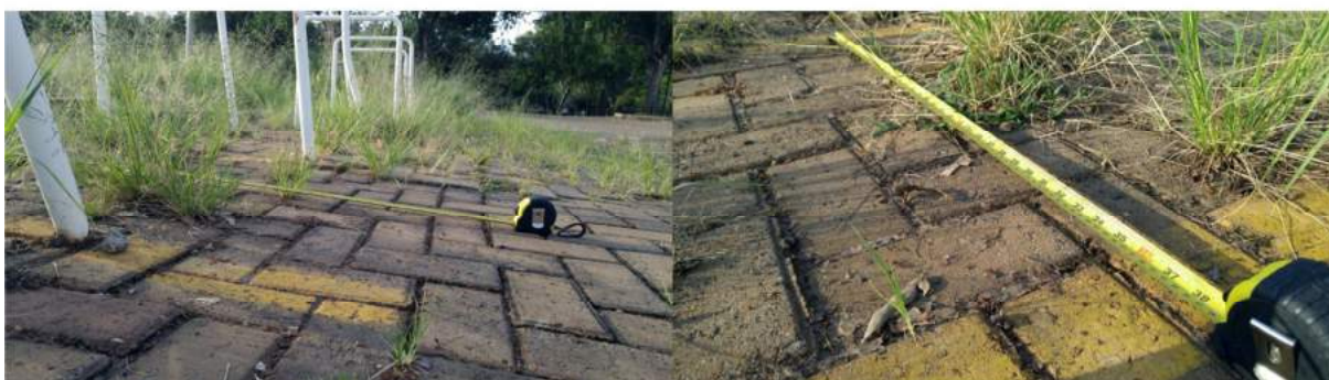
Figura 52 – Estacionamento do Ginásio de Esportes – Blocos do piso desalinhado.
