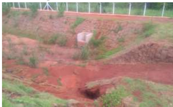
Figura 81 – Erosão nos taludes internos da quarta bacia do SBD 4
