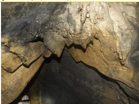
Figura 76 - Presença de fuligem de gás acetileno em algumas partes do teto da cavidade (P1).
