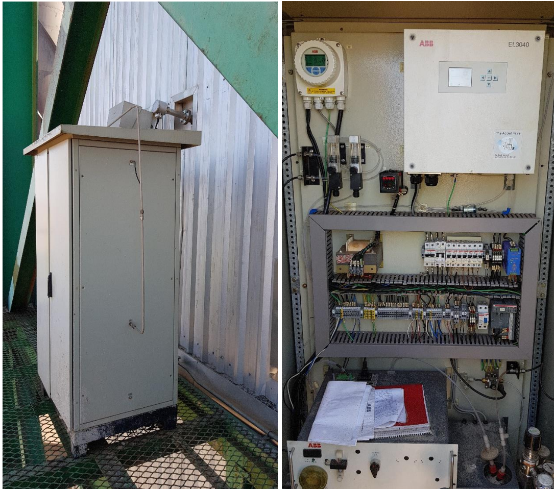
Figura 17. Cubículo com transmissores remotos de O_2 e CO , com vista externa (esq.) e interna (dir.). Fonte: acervo pessoal.
