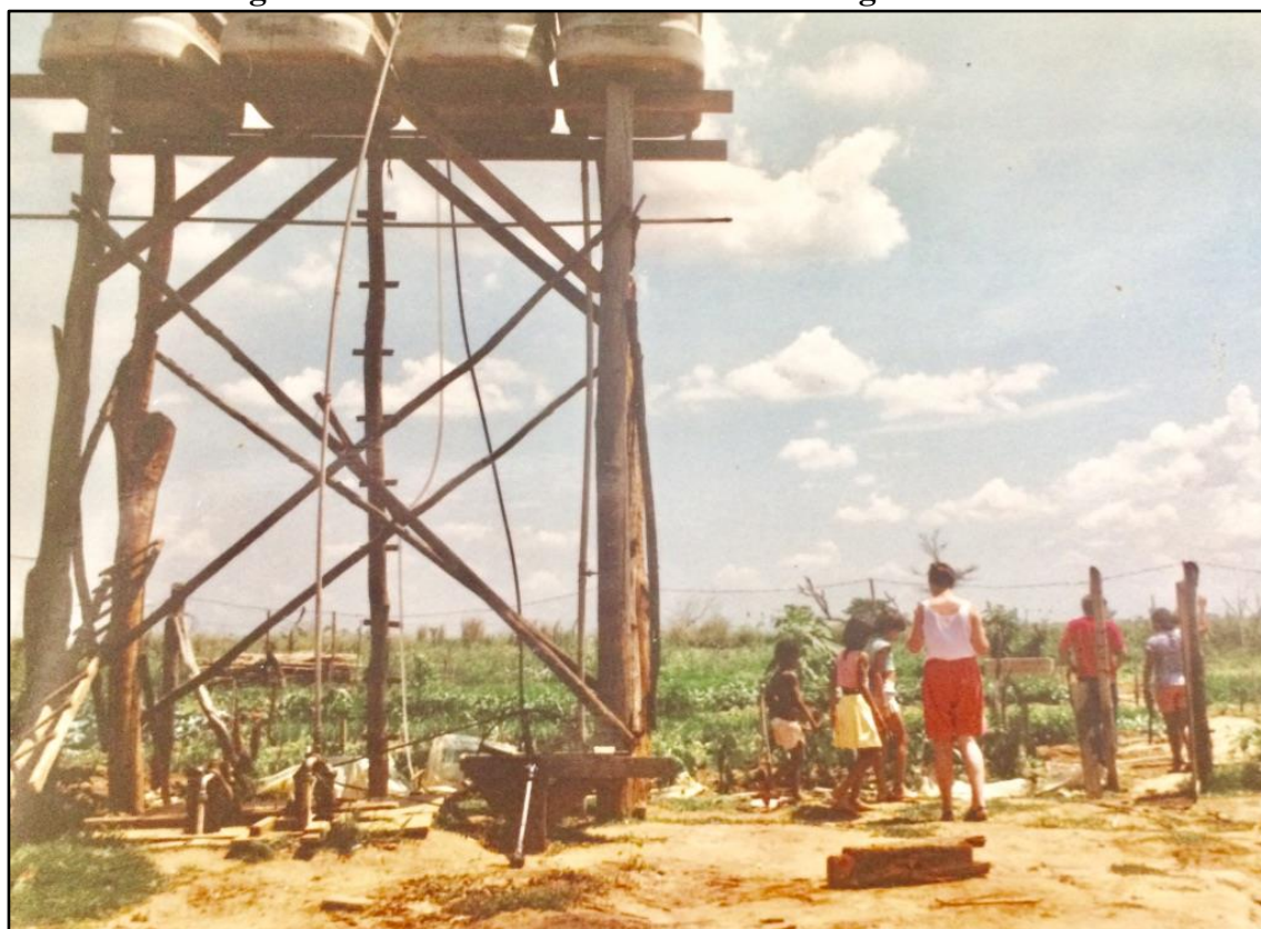
Figura 11 – Sistema de bombeamento de água mecânico
