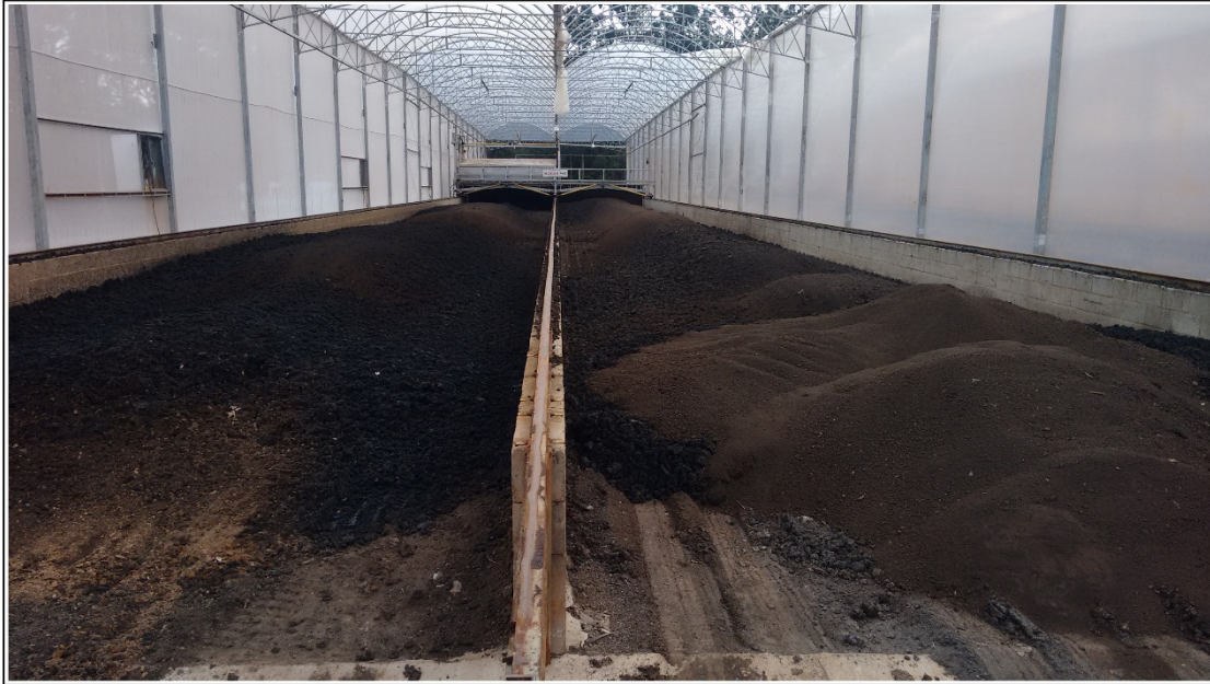
Figura 26. Estufa de desaguamento e secagem de lodo
