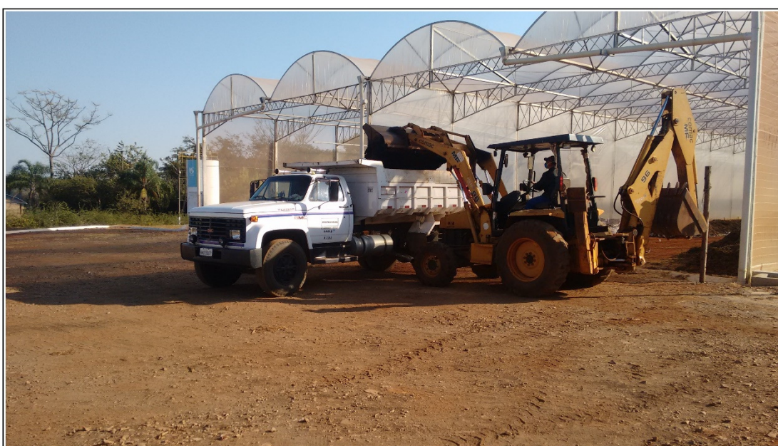
Figura 32. Mistura na Proporção 1:1 de lodo e esgoto e casca de eucalipto em caminhão caçamba
