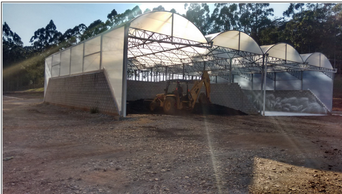
Figura 28. Estufa de armazenamento de lodo e material estruturante para compostagem
