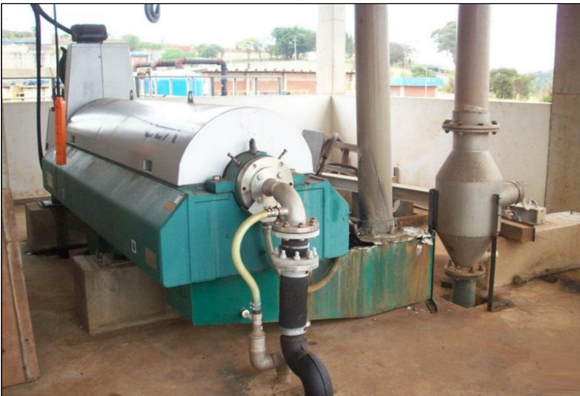
Figura 17. Centrífuga da ETE-Monjolinho
