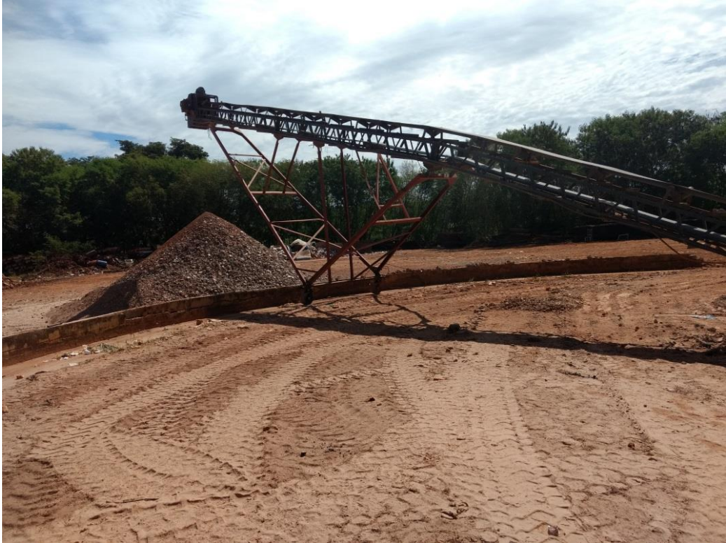
Figura 30 - Correia transportadora da usina de reciclagem de RCC de SJRP.
