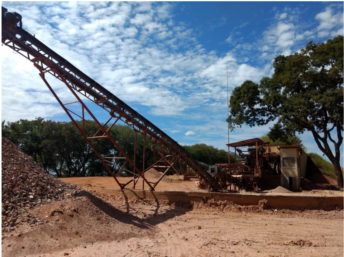
Figura 14 - Equipamentos da usina de reciclagem de RCC de SJRP.
