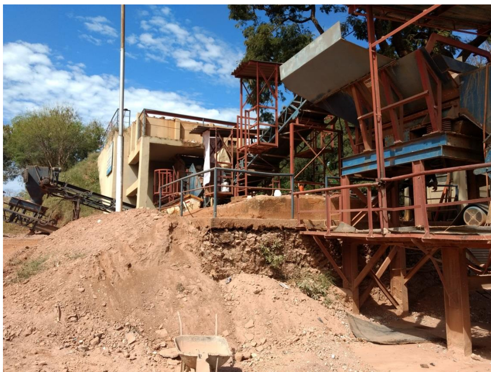
Figura 29 - Equipamentos alimentador vibratório, esteira com eletroímã e britador de impacto, da usina de reciclagem de RCC de SJRP.
