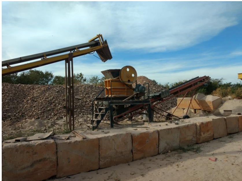
Figura 48 - Esteiras transportadoras e britador de mandíbula da usina de reciclagem de RCC de Bady Bassitt.
