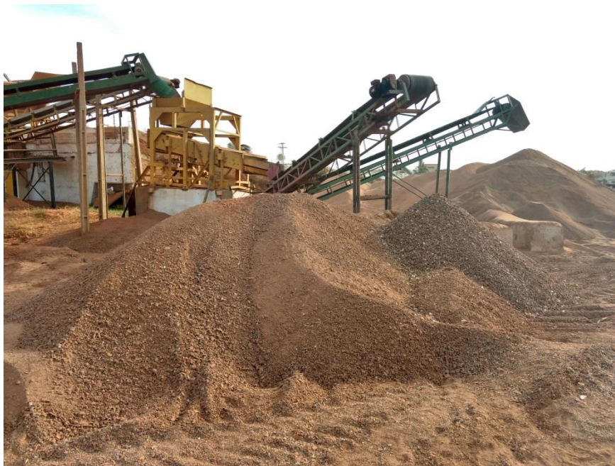
Figura 50 - Esteira transportadora e pilhas de brita da usina de reciclagem de RCC de Bady Bassitt.
