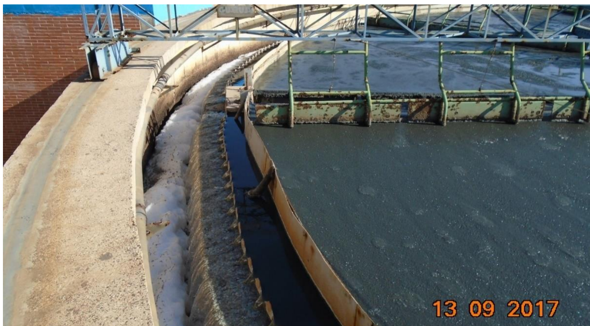
Figura 6.10 - Raspadores e canaletas para remoção do LETE no Flotador
