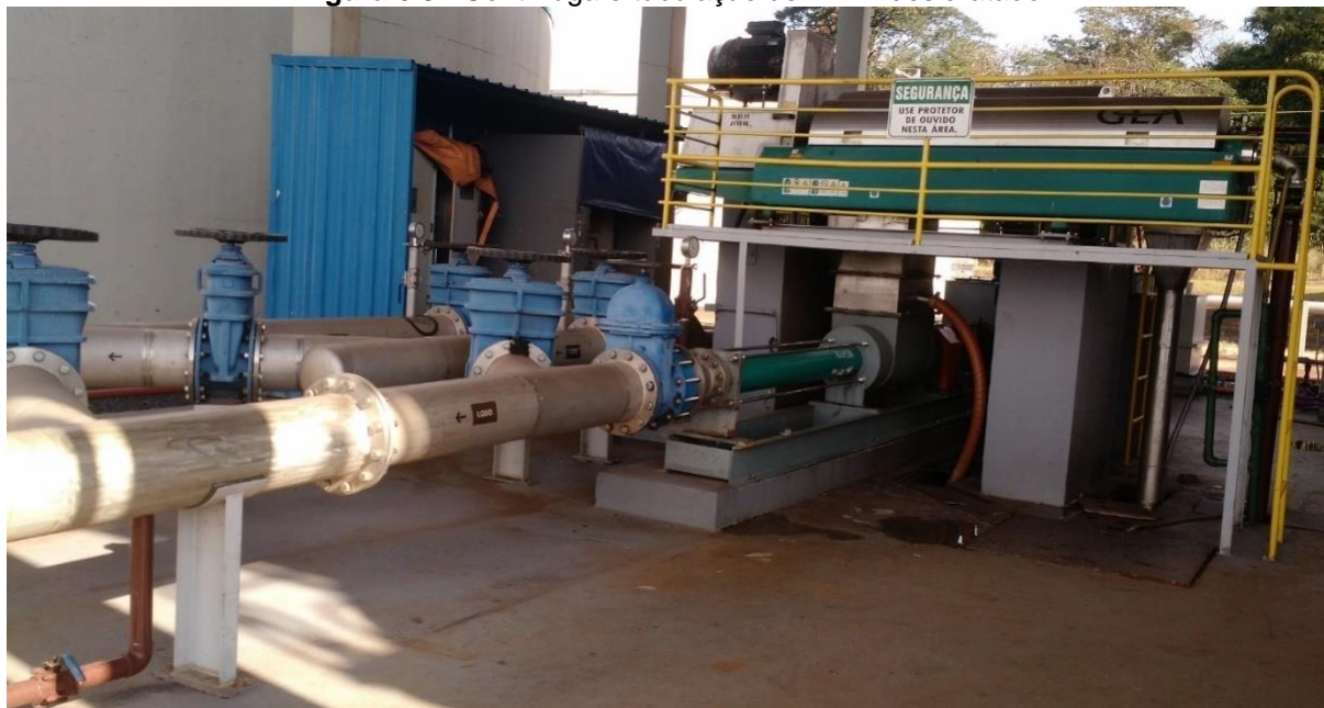
Figura 6.3 - Centrífuga e tubulação de LETE desidratado
