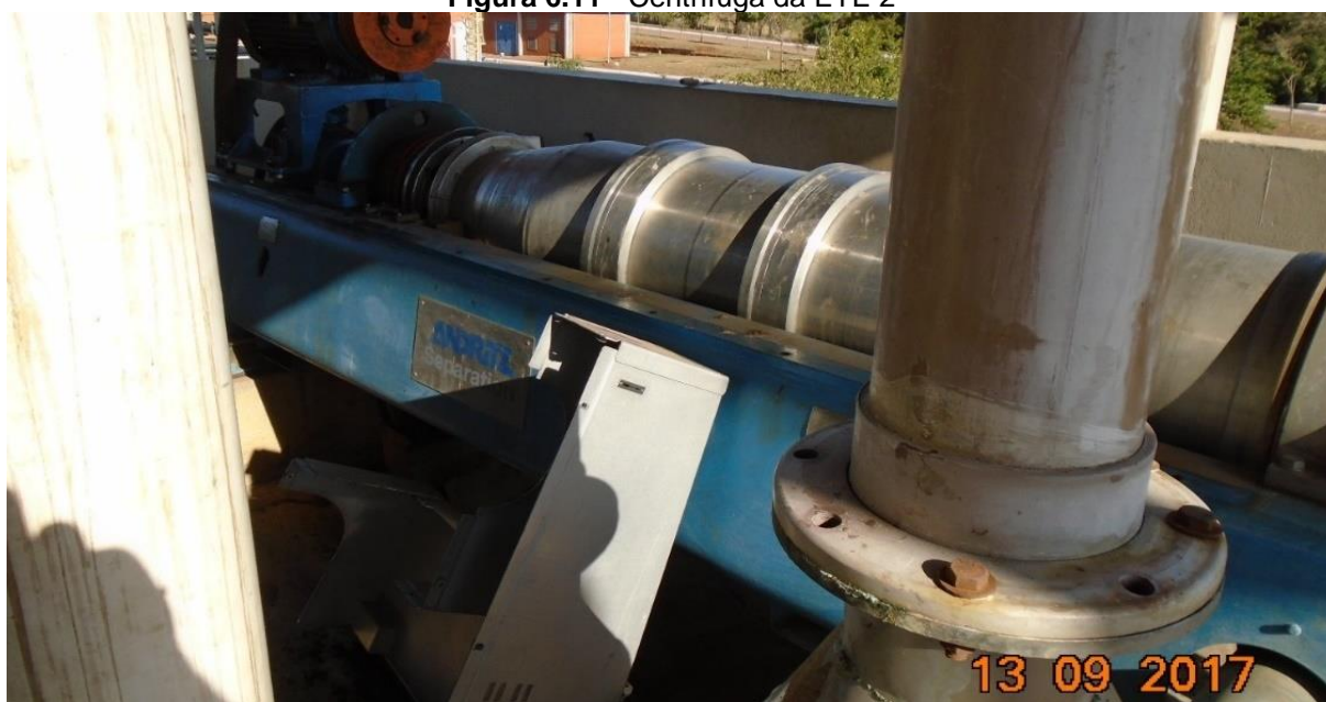
Figura 6.11 - Centrífuga da ETE 2
