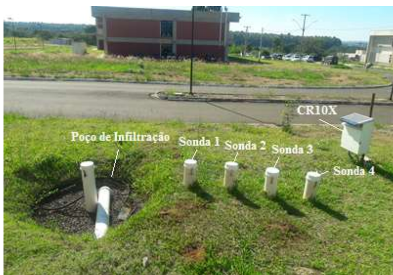
Figura 3.13 - Sondas instaladas para monitorar a umidade volumétrica do solo na área do entorno do PGHidro
