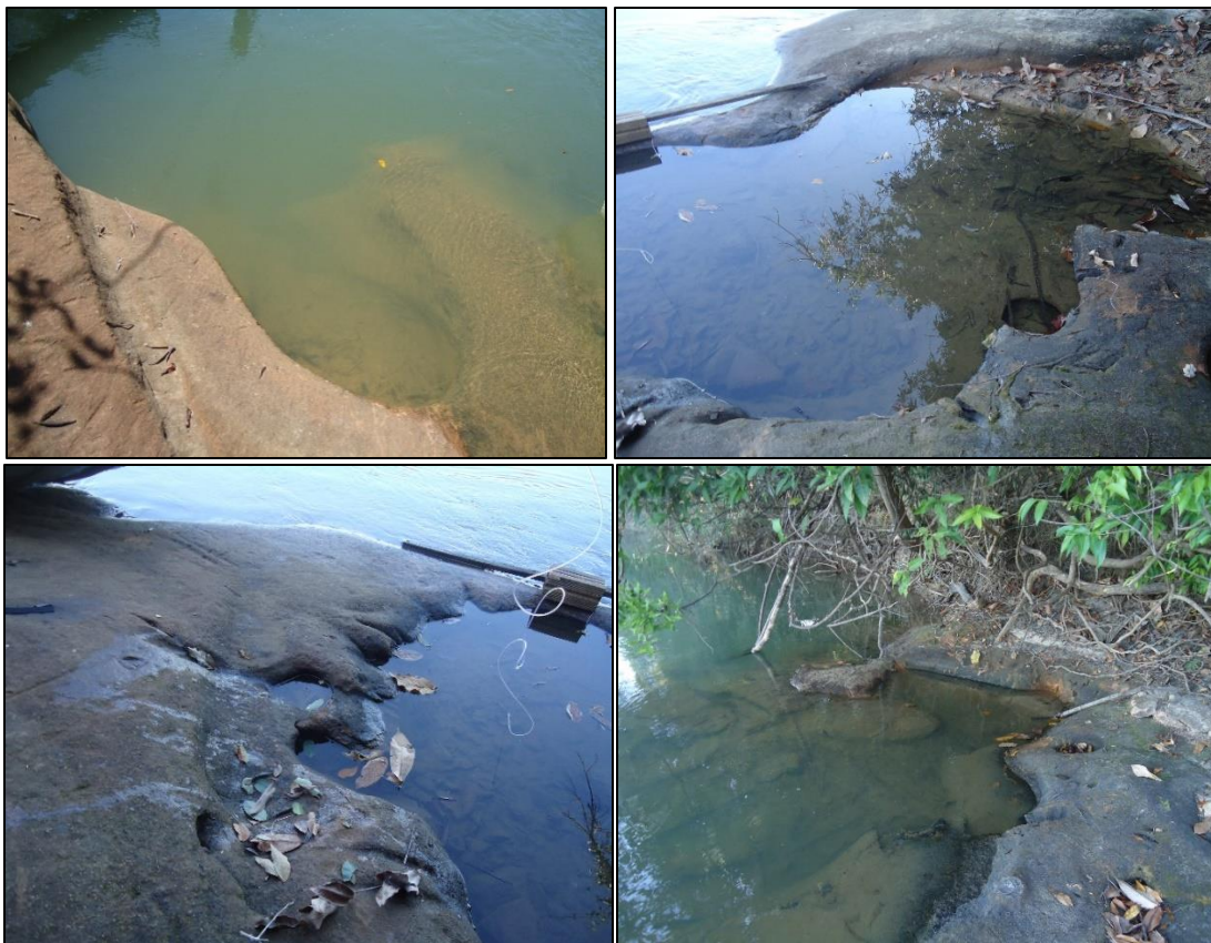
Figura 52. Afloramento rochoso e impacto hidráulico nas margens Foto: Leila Nalis Paiva da Silva Andrade (2016)
