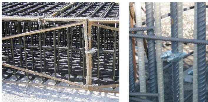
Detalhe da gaiola provisória em aço e sistema de fixação com grampo "U"
