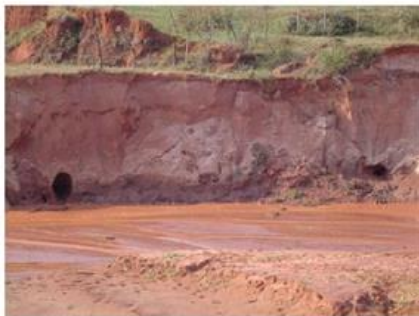
Figura 14: Formação de orifício na base do talude, devido à concentração de água do lençol freático (fenômeno de piping ), no município de Paraguaçu-Paulista (SP). Fonte: IPT, 2013
