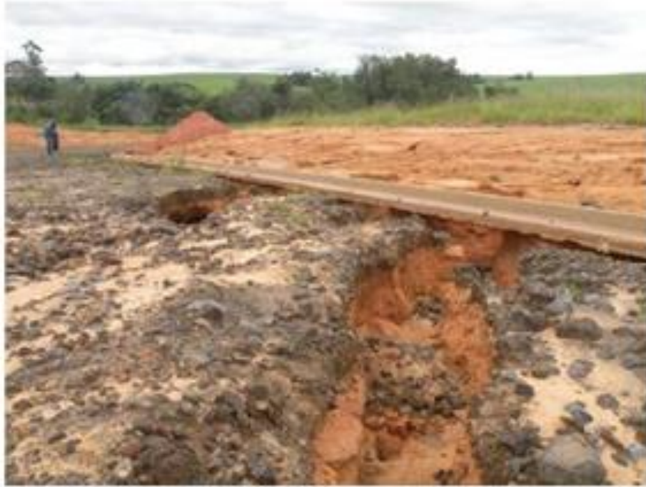
Figura 10: Formação de sulcos em área de entorno de sistema viário devido à falta de pavimentação no município de Porto Feliz (SP). Fonte: IPT, 2013
