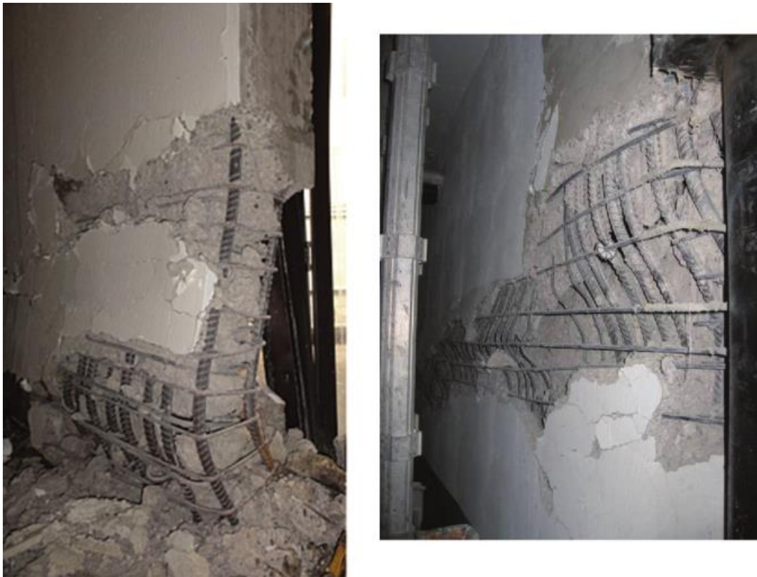
Figura 2.1. Instabilidade em paredes estruturais de edifícios solicitadas a sismos.
