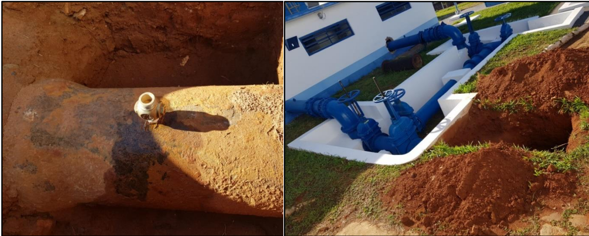
(a) TAP instalado na linha de recalque
