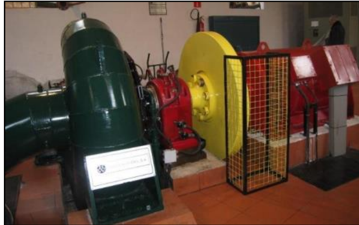
Figura 28 - Instalação de bombeamento equipada com volante de inércia
