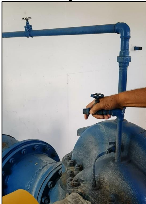
(a) Abertura do registro para escorva da bomba
