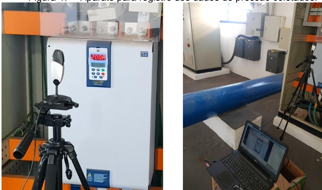
(a) Dispositivo para filmagem da corrente elétrica
