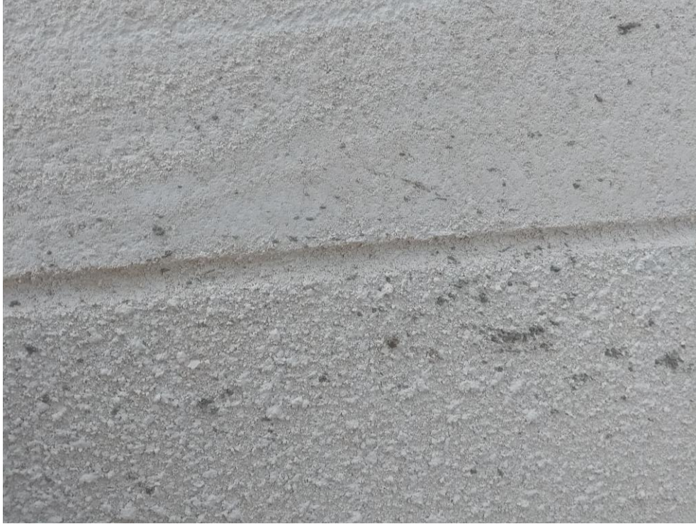
Figura 71 - Junta de trabalho, com acabamento jateado na parte inferior e sem acabamento na superior
