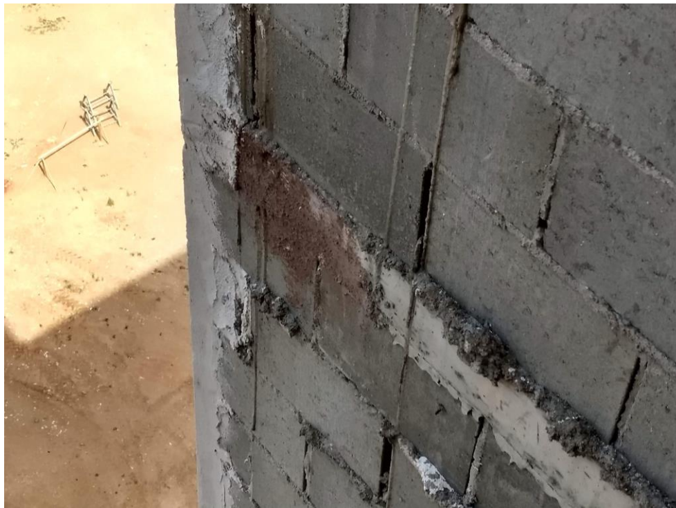
Figura 44 - Excesso de argamassa nas juntas da alvenaria e laje
