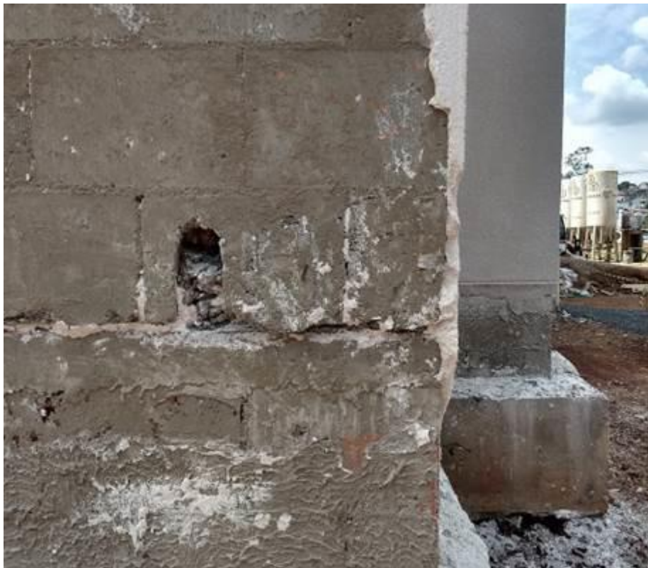
Figura 30 - Detalhe do local onde ocorreu descolamento de placas
