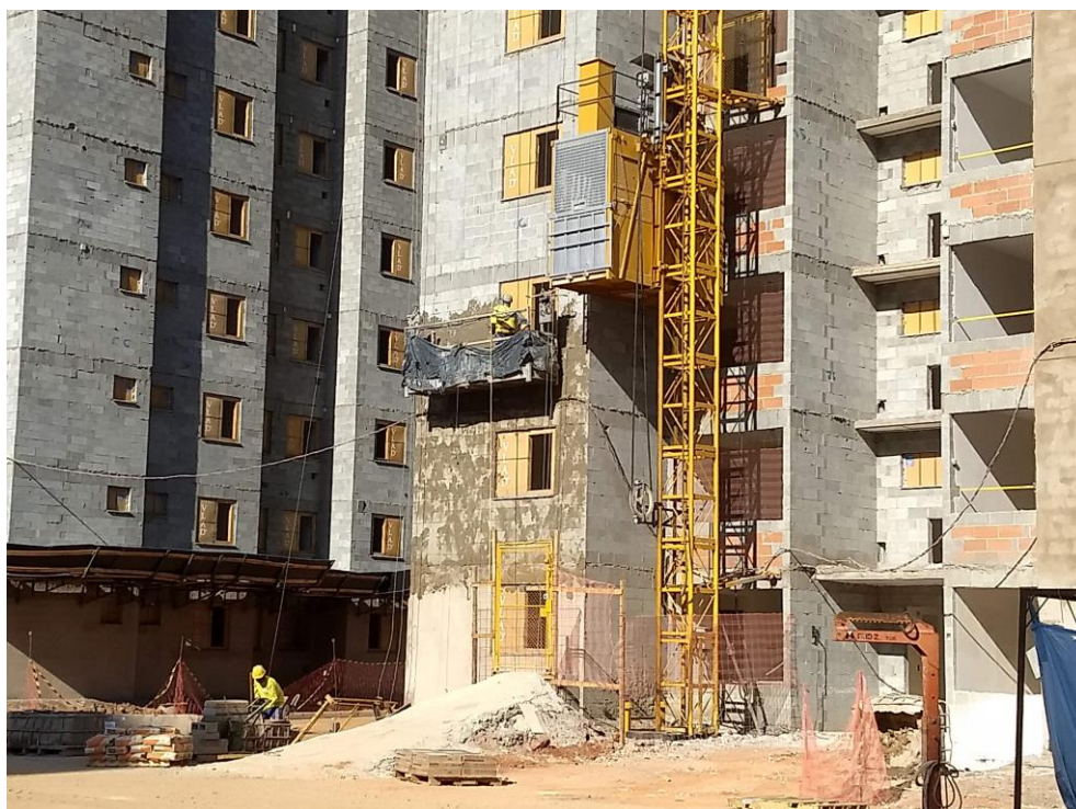
Figura 45 – Segunda subida com realização do preparo de base, com aplicação do chapisco
