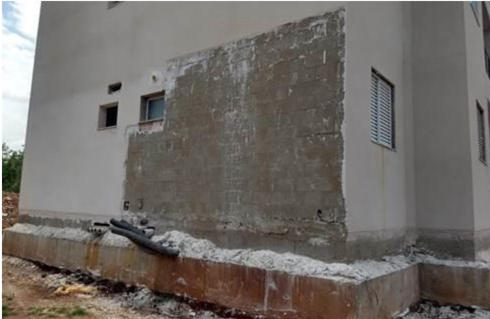
Figura 29 – Parte da fachada que apresentou patologia, ocasionando em retrabalho
