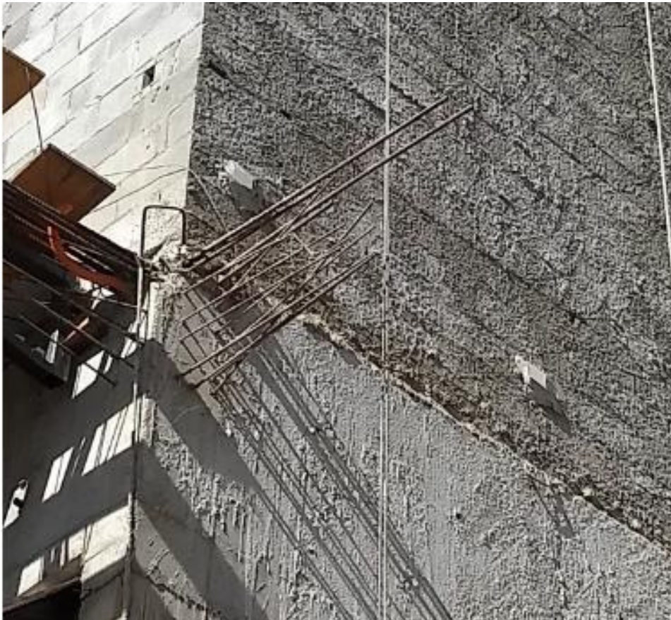
Figura 40 - Exemplo de material que projeta da fachada e necessita ser removido
