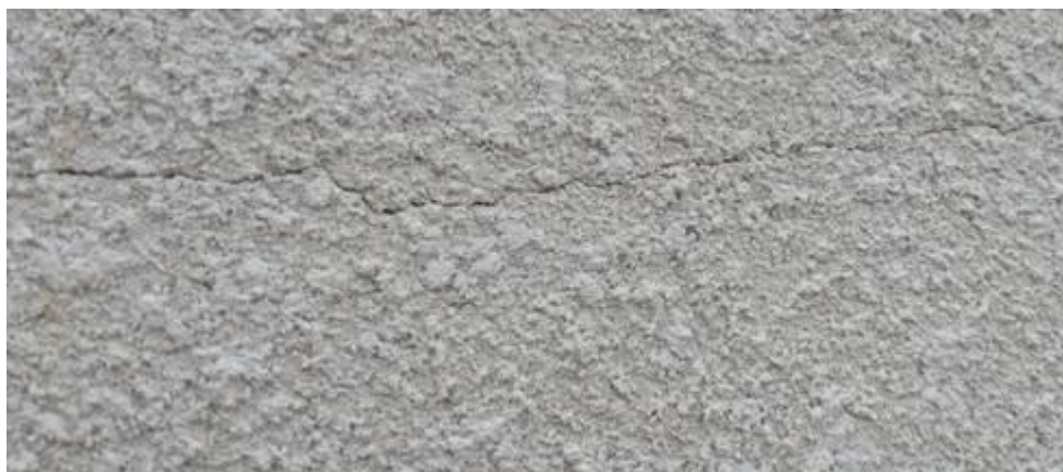
Figura 31 - Fissuras causadas por falha nas operações de execução das fachadas
