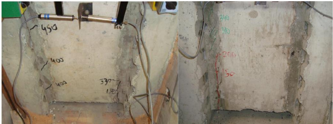
Figura 4-8: Fissuras nos protótipos PR1 e PR2
